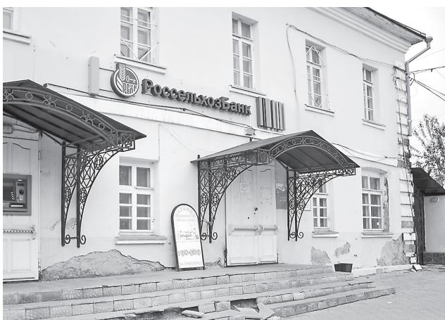
Обвалившаяся штукатурка, разрушенное крыльцо не красят центр города
