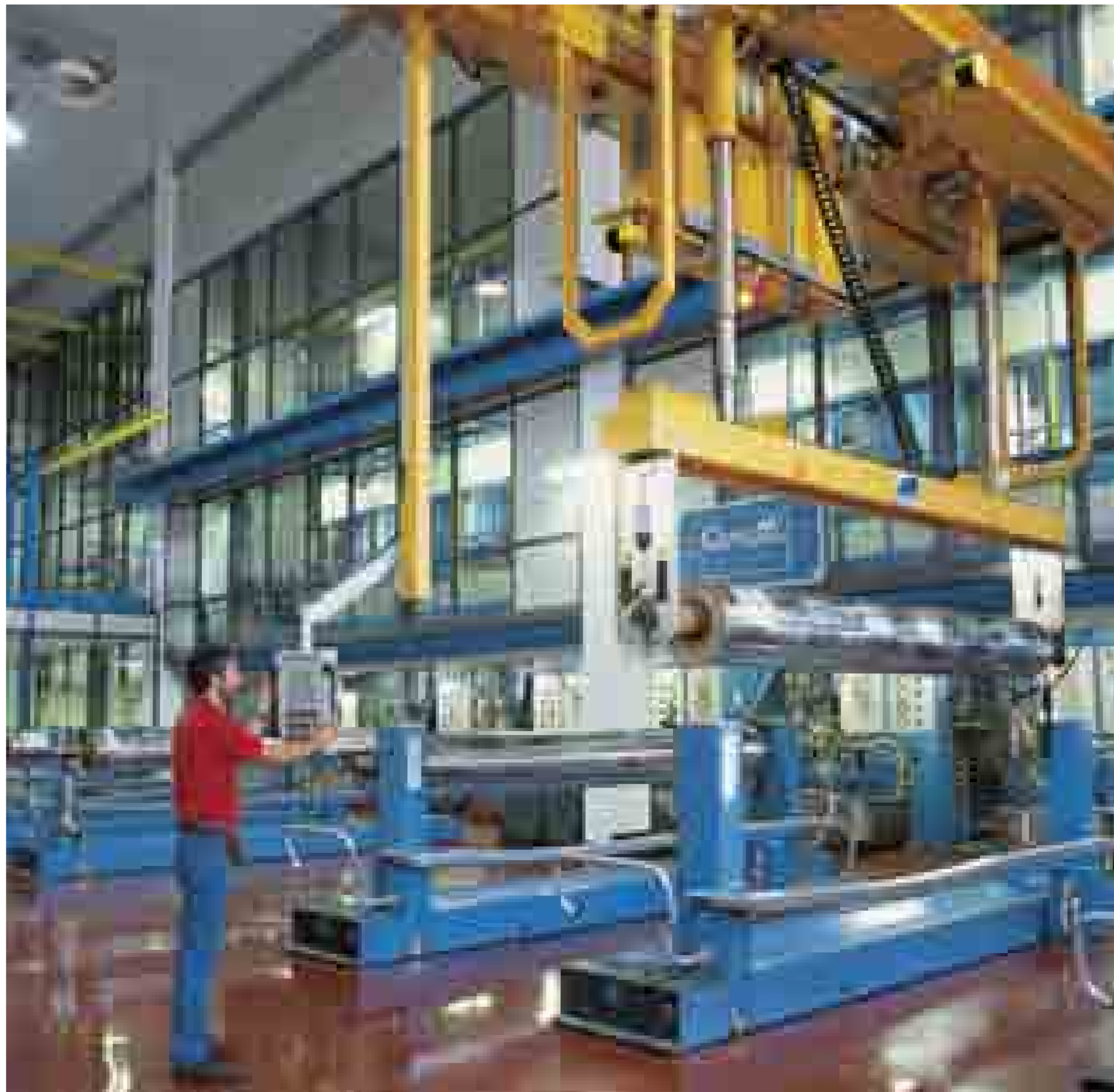
218 La nuova rotativa Super 10 nello stabilimento di Verona. L'impianto rappresenta la prima installazione in Europa di una rotativa di larghezza utile di 3,62 metri.
