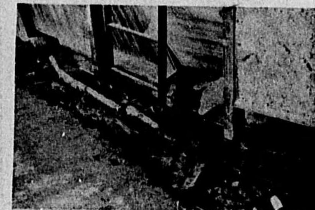
幸町 沈下セル家屋ノ床下部分
