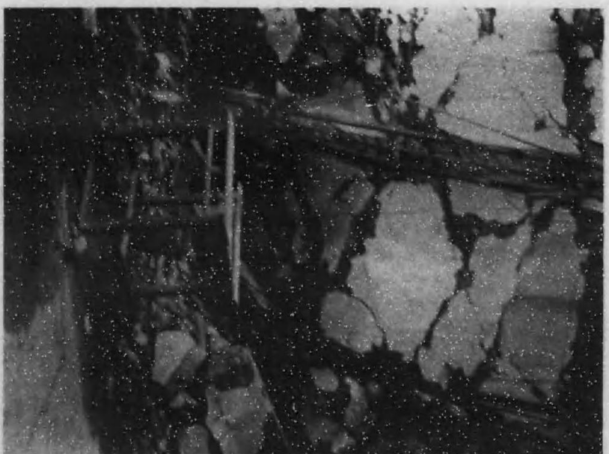
堤崩の梁及板床階四
