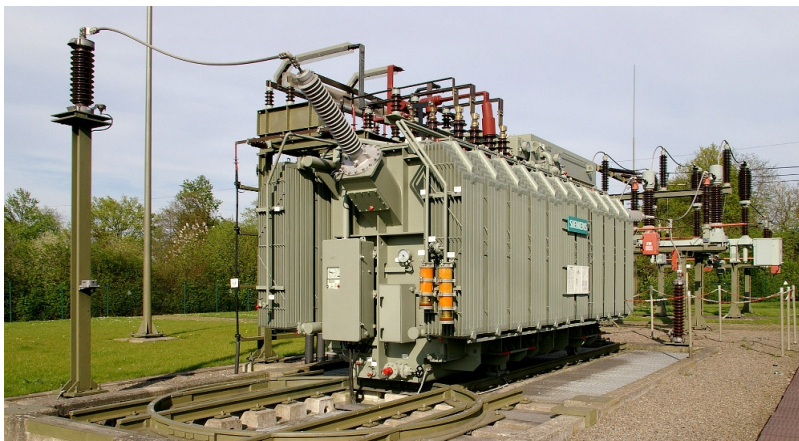
Fig. 189: Transformilo en elektrejo
