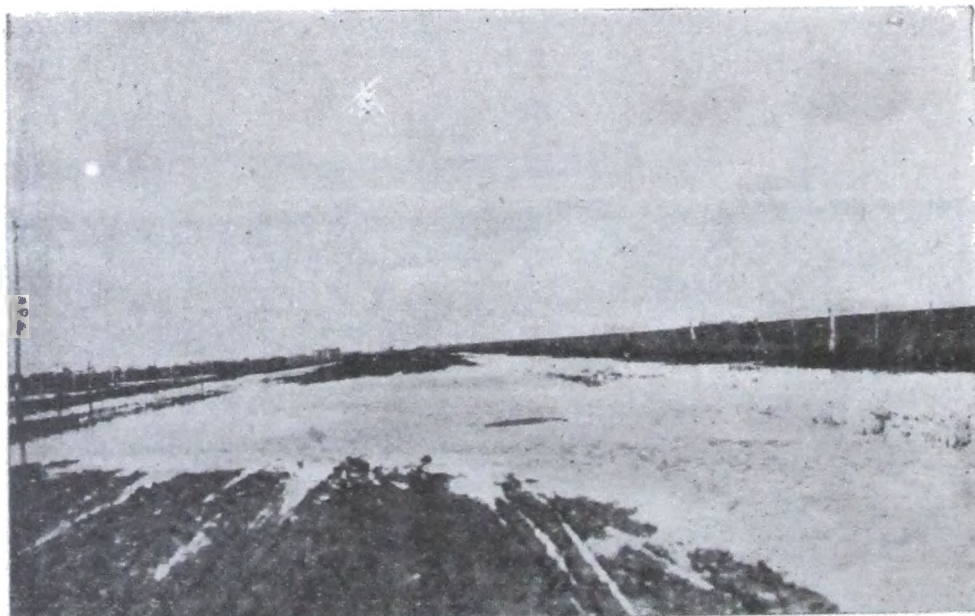
Camino de Bragado a Nueve de Julio; tramo Bragado - Olascoaga. Cortadura producido por las lluvias, deficiencia de terraplenes y desagües.
