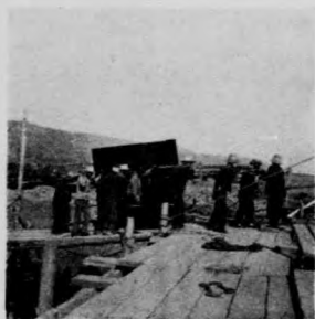
冲刷閘裝置鋼閘門
