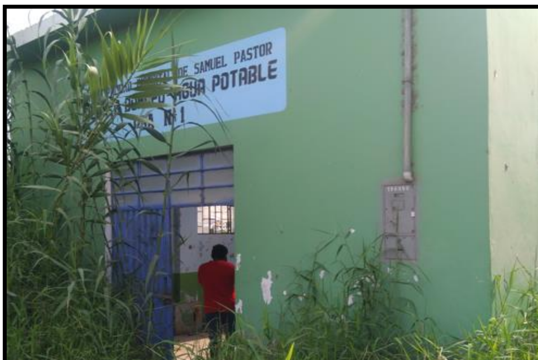
Anexo 27. Fotografía de ubicación de pozo de agua (inventario de Notas de agua)
