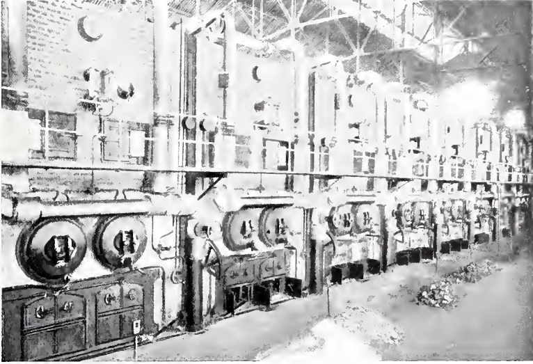
MACCHINARIO E BATTERIA DI CALDAIE DEI PRIMI DUE IMPIANTI DI SOLLEVAMENTO.
