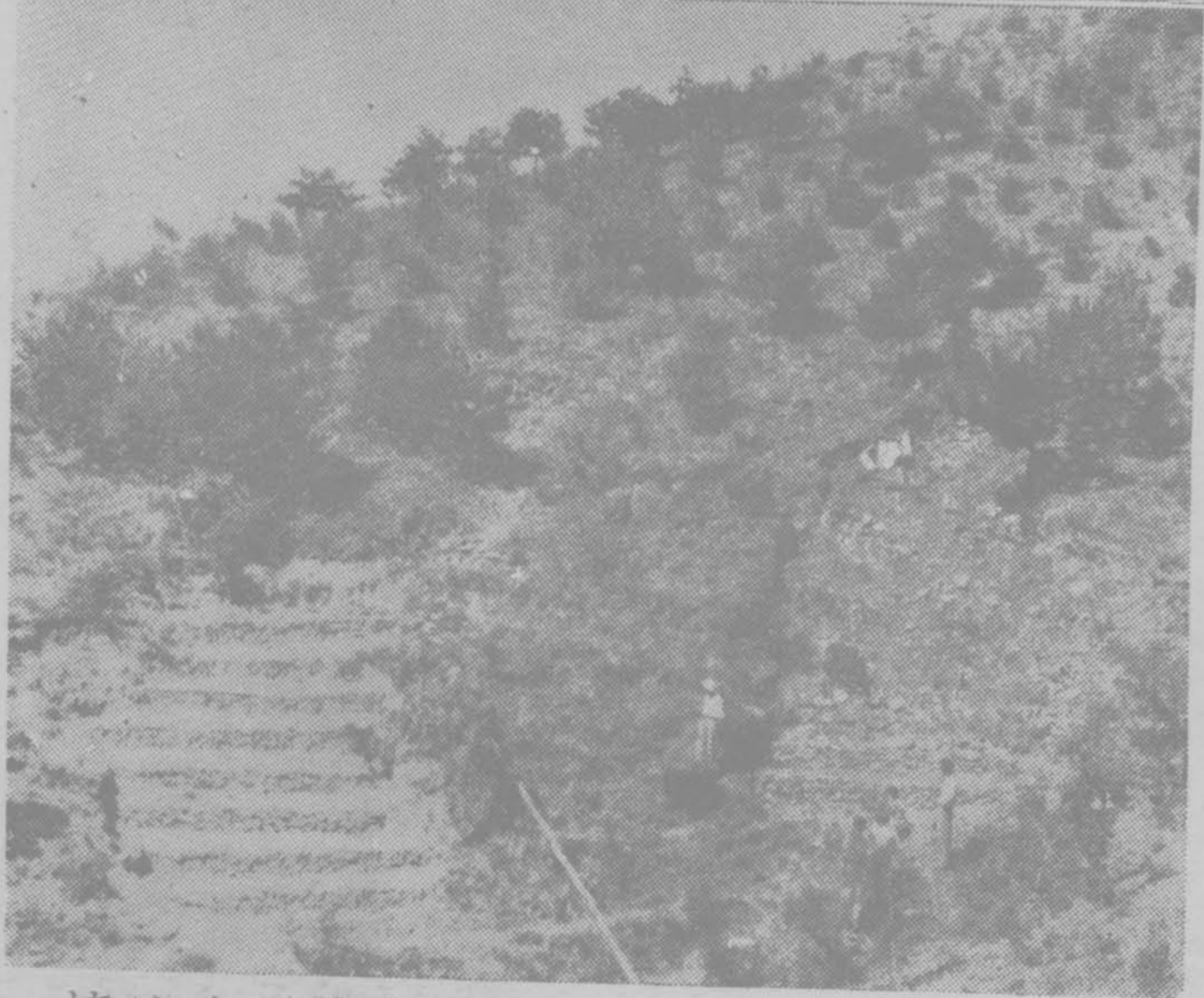
中林 所南 場西 山塊 狀冲 刷地 山坡 傾斜 為 45^{\circ} 正在 施工 築台 而後 造林 植草 情形
