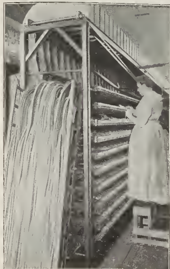
La batería americana, recientemente instalada y destinada al servicio de 160 series de abonados, tal como era antes del incendio.
