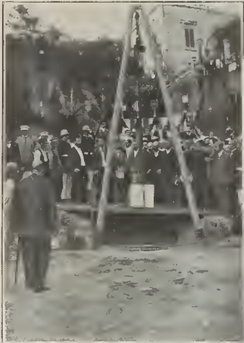
Barcelona. — Colocación de la primera piedra del viaducto que ha de unir la barriada de Vallcarca con San Gervasio
