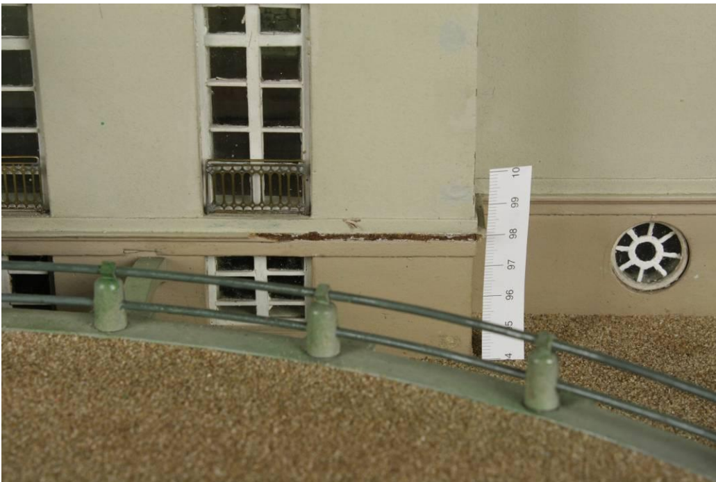
Abb.5: Vorzustand einer der beiden abgebrochenen Simsleisten, Detailansicht.
