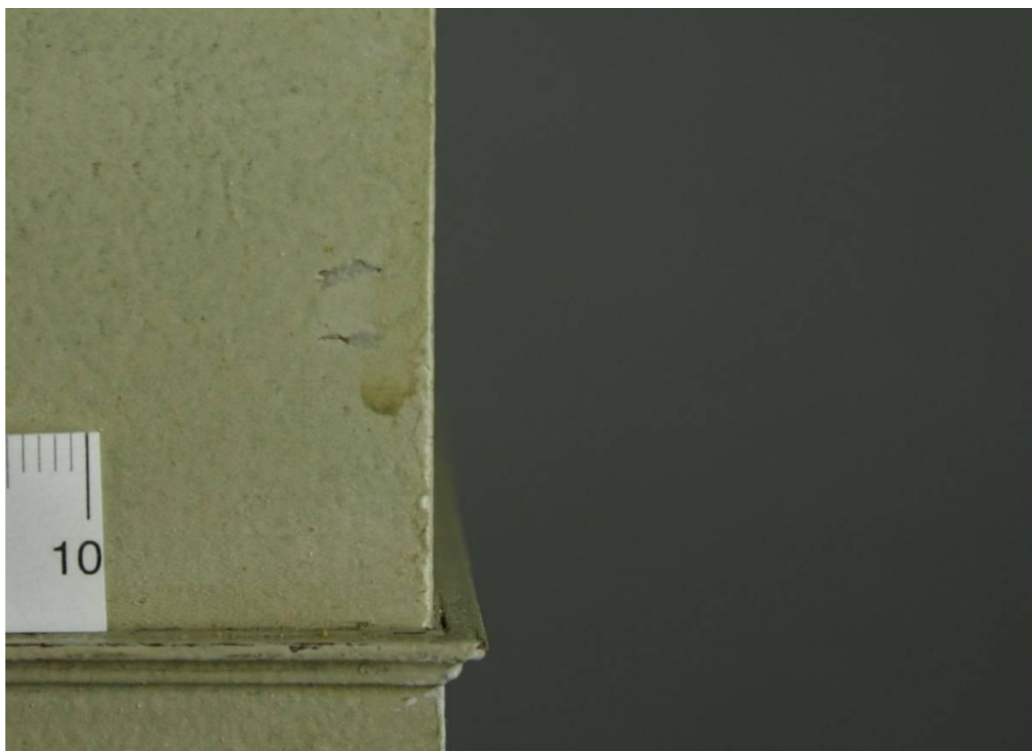
Abb.9: Vorzustand abgeplatzter Nagelkopf und „Laufnase“, Detailansicht.
