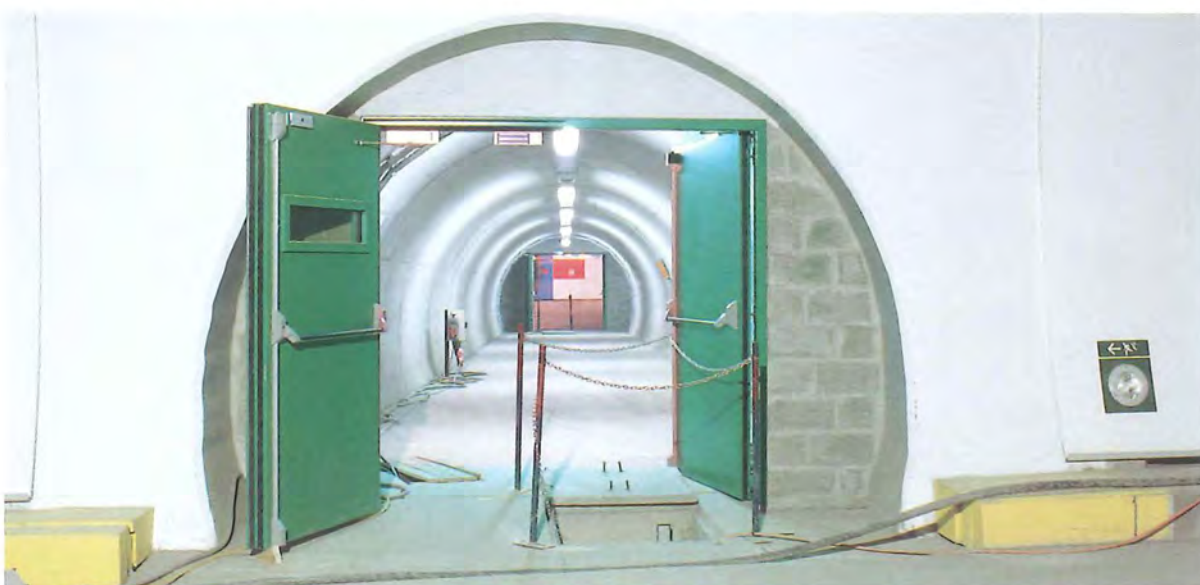
Figure 117 : galerie de liaison entre les deux tunnels de Cointe – Ces galeries permettent l'évacuation, vers l'autre tunnel, des occupants des véhicules, éventuellement impliqués dans un incident (avril 2000). • © Daylight
