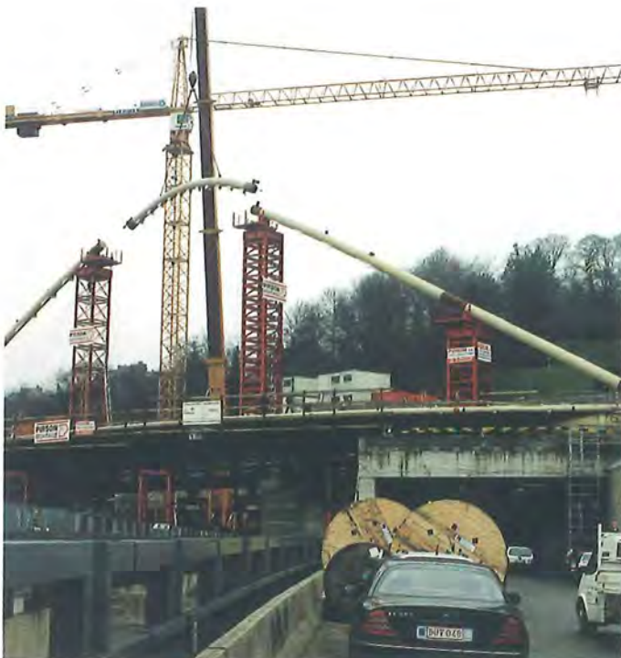
Figure 29 : mise en place du cinquième élément d'arc, la clef de voûte, de l'arc du Bowstring, le 16 mars 2000 • © D. Verlaine
