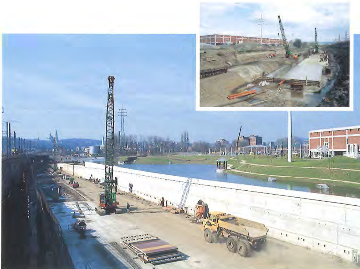
Figures 103 et 104 : les travaux de réalisation de l'extrémité du tunnel et de la tranchée ouverte entre le canal de l'Ourthe et le chemin de fer – Construction de la demi-chaussée nord, en avril 1997 (en vignette), et de la demi-chaussée sud, en mars 1998 © Daylight
