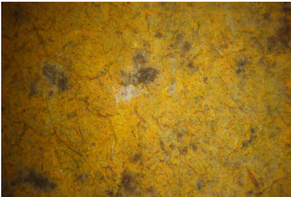
Ablagerungen auf der Oberseite der Bodenplatte
