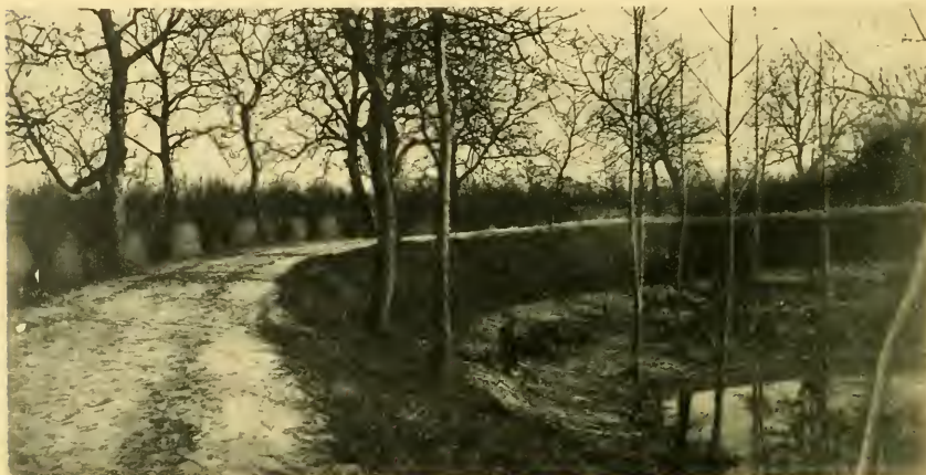
Phot. 67. Digue du polder de Hamme (en face de Thielrode), après rupture de la digue, à Drijgoten. Le polder est encore inondé. — Avril 1906.
