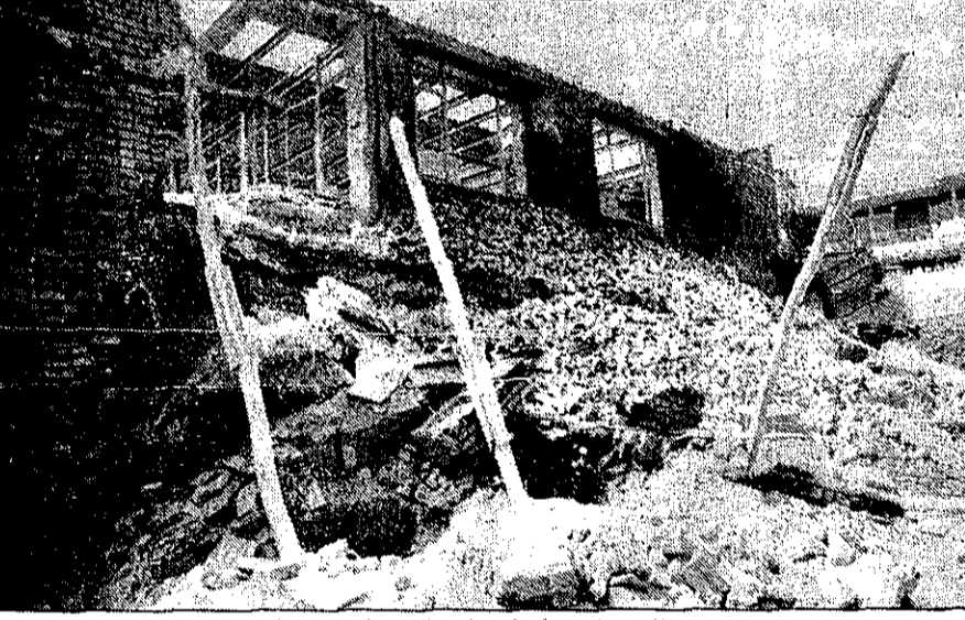
در اثر ریزش دیوار یک ساختمان نوساز در خیابان فرح شمالی ۴ کارگر زیر آوار ماندند.
