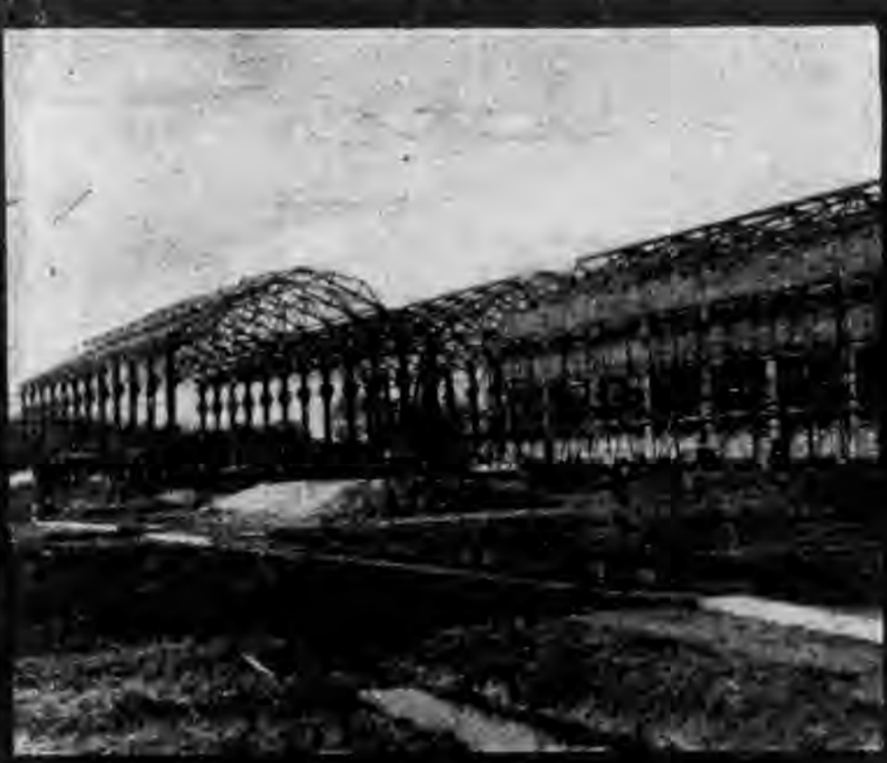
←中央機器，鍊鋼，製鐵三廠。實業部在上海北新建築中之情形。
