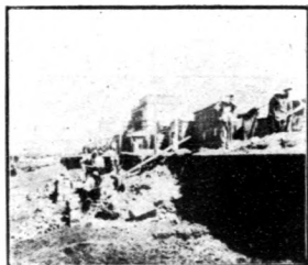
修理南運河大王廟對過之磚 壩工程原有磚壩損壞情形
