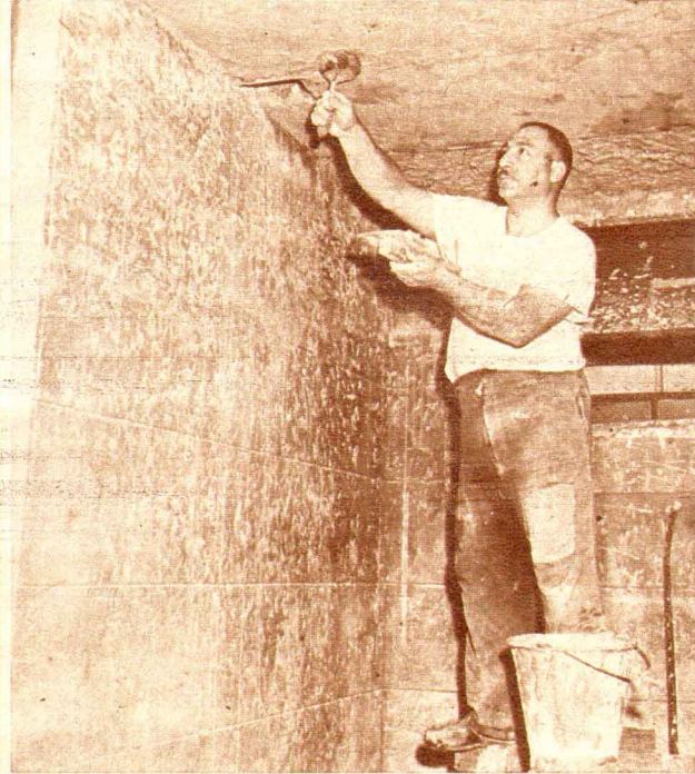
También es un excelente albañil este suboficial bombero, que está terminando la construcción de un depósito para su cuartel.
