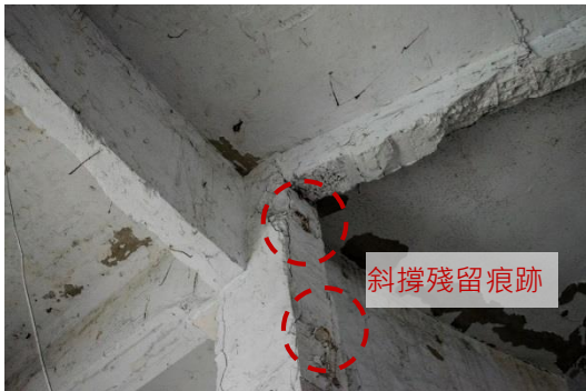
圖 3-3-43 眺台下方斜撐殘留之鋼構痕跡-1
