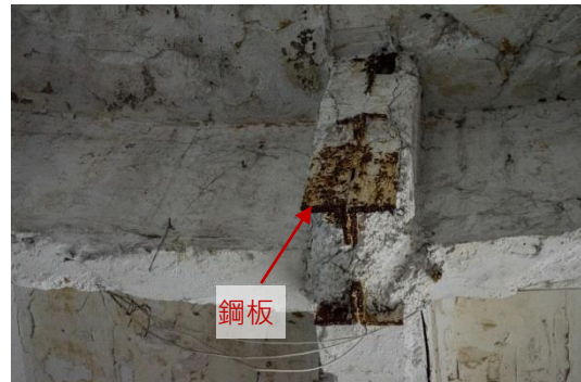
圖 3-3-44 眺台下方斜撐殘留之鋼構痕跡-2
