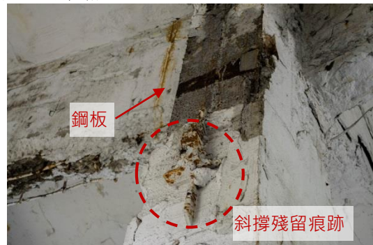
圖 3-3-46 眺台下方斜撐殘留之鋼構痕跡-4
