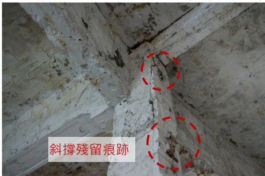
圖 3-3-45 眺台下方斜撐殘留之鋼構痕跡-3
