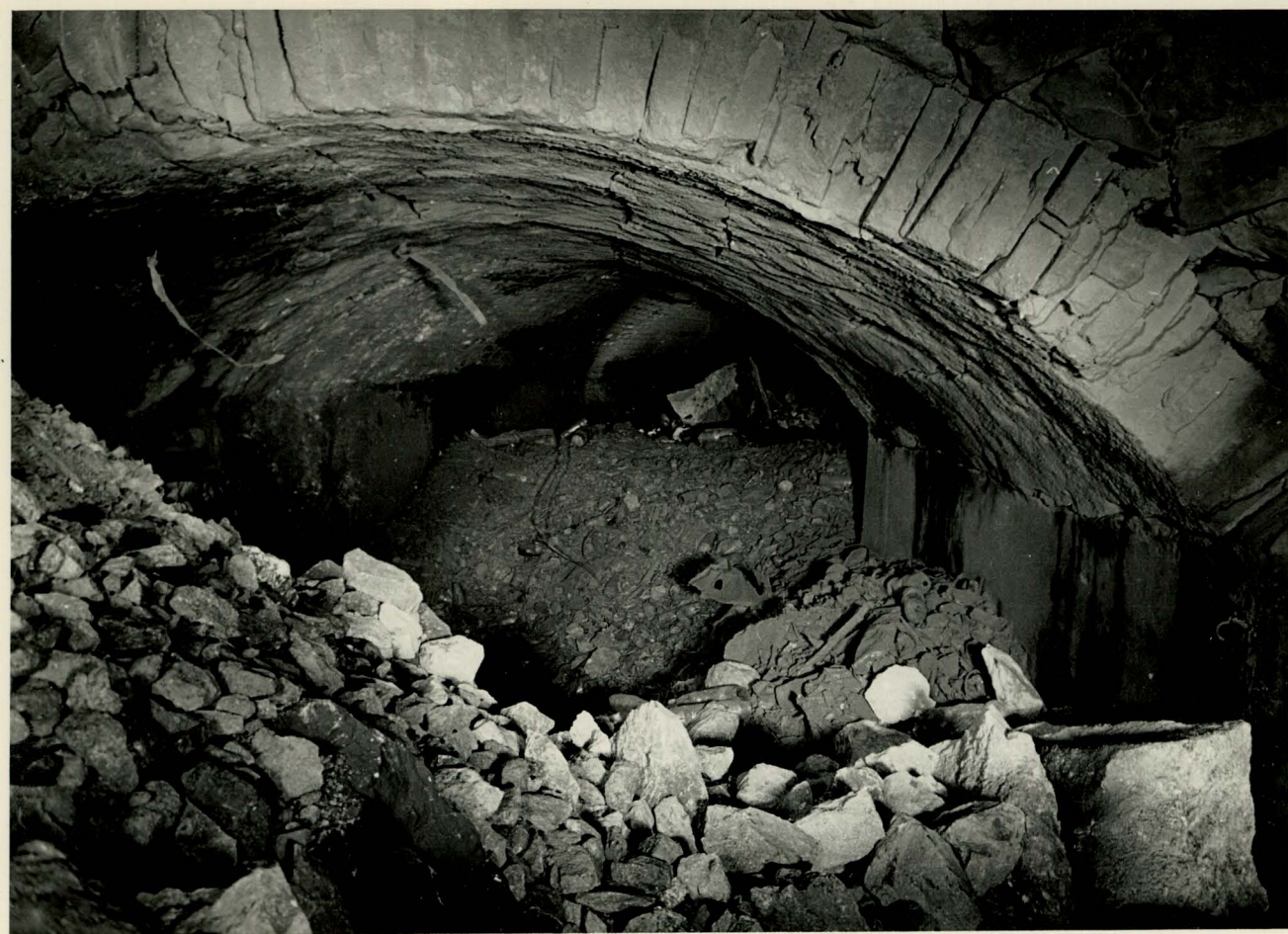
Photo 121: Blick in die W.-C.-Anlage. Vor der Kammer VI war die Aussenwand durch den Einbau der Abortanlage stark geschwächt. Trotzdem blieb dieser Bauteil gut erhalten, auf der grössern Strecke sogar mit dem Gewölbe.
