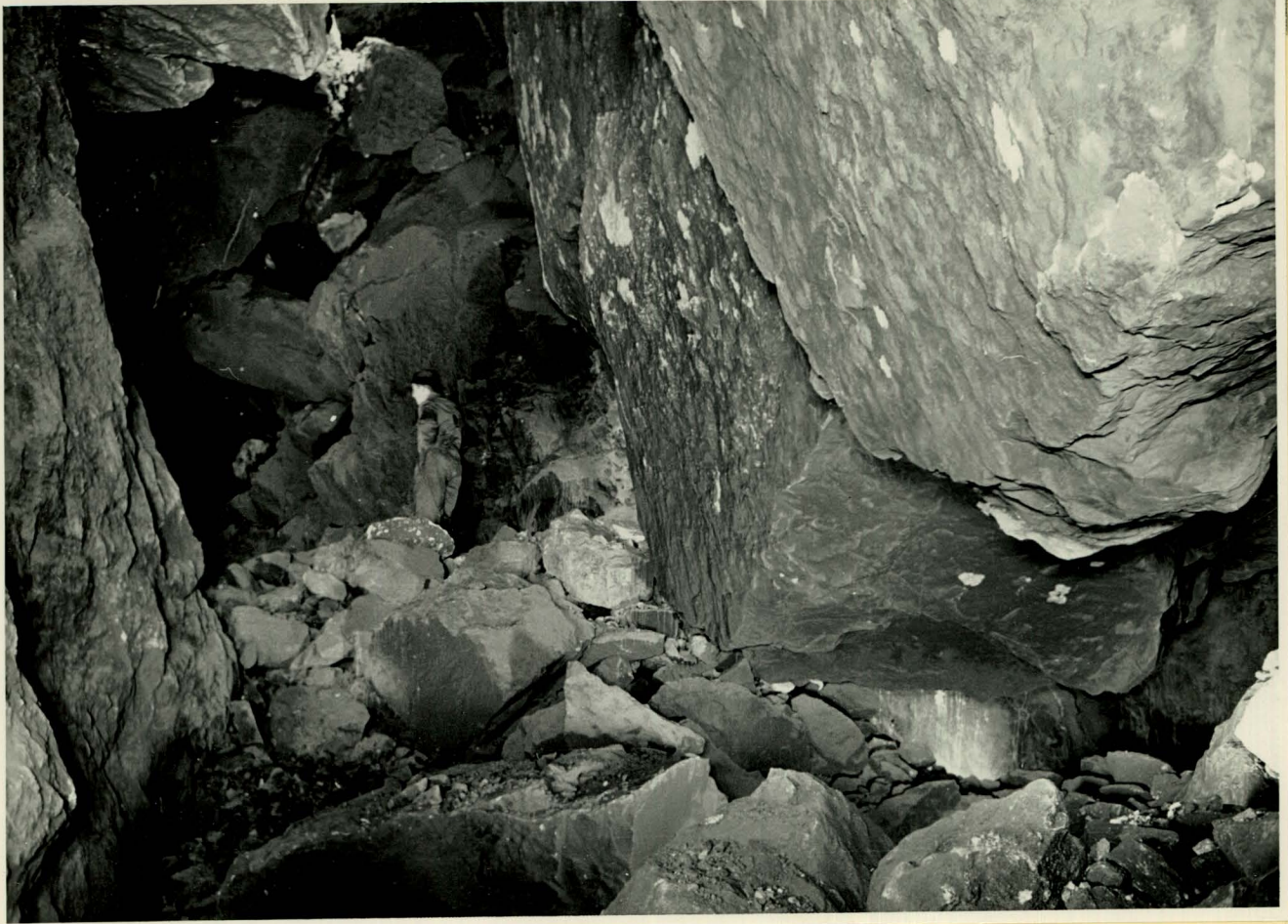
Photo 116 : Blick quer zum Bahnstollen, jedoch über dessen Scheitel, zum Aufnahmeort 114. Felslamellen mit grossen Zwischenräumen.
