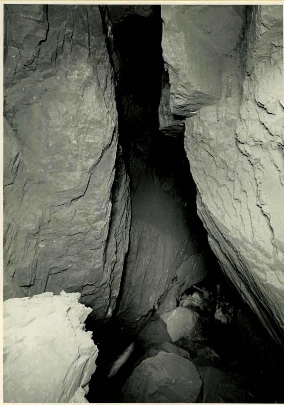
Photo 124: Kluft längs der Westwand des Bahnstollens über dem Boden. Sie reicht noch mehr als 8 m unter die Tunnelsohle hinab und ermöglichte die Verlagerung der Aussenwand und damit den Einsturz der Felslamellen. Blick gegen Norden zwischen K. V und VI.
