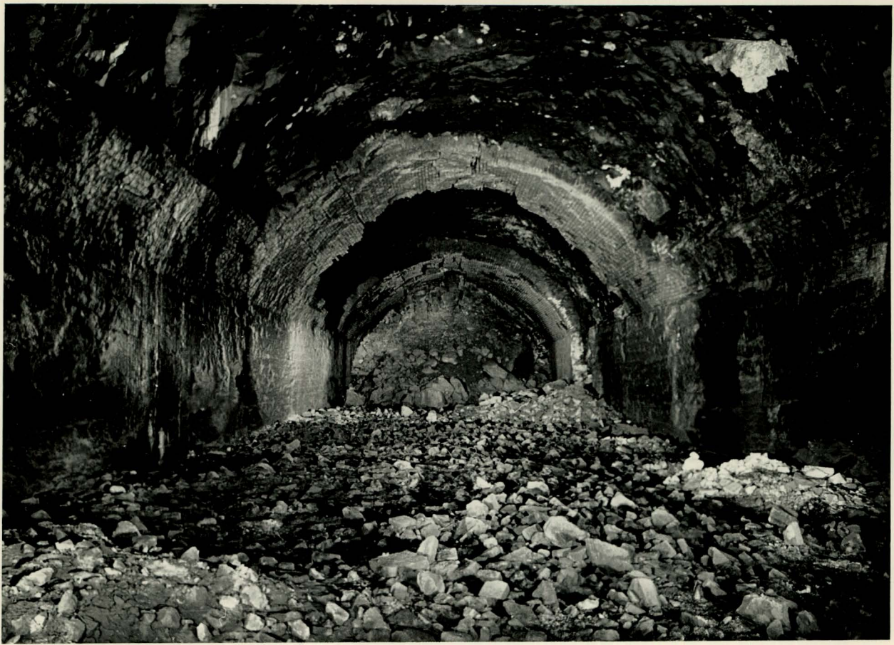
Photo 31 : Versturz der Kammer I gegen den Verladestollen. Die erhaltene Ausmauerung beweist, dass er vor der grössten Detonation erfolgte. Die Diagonalkluft quert schief die zuhinterst sichtbare gut erhaltene dicke Ausmauerung mit Tunnelsteinen.
