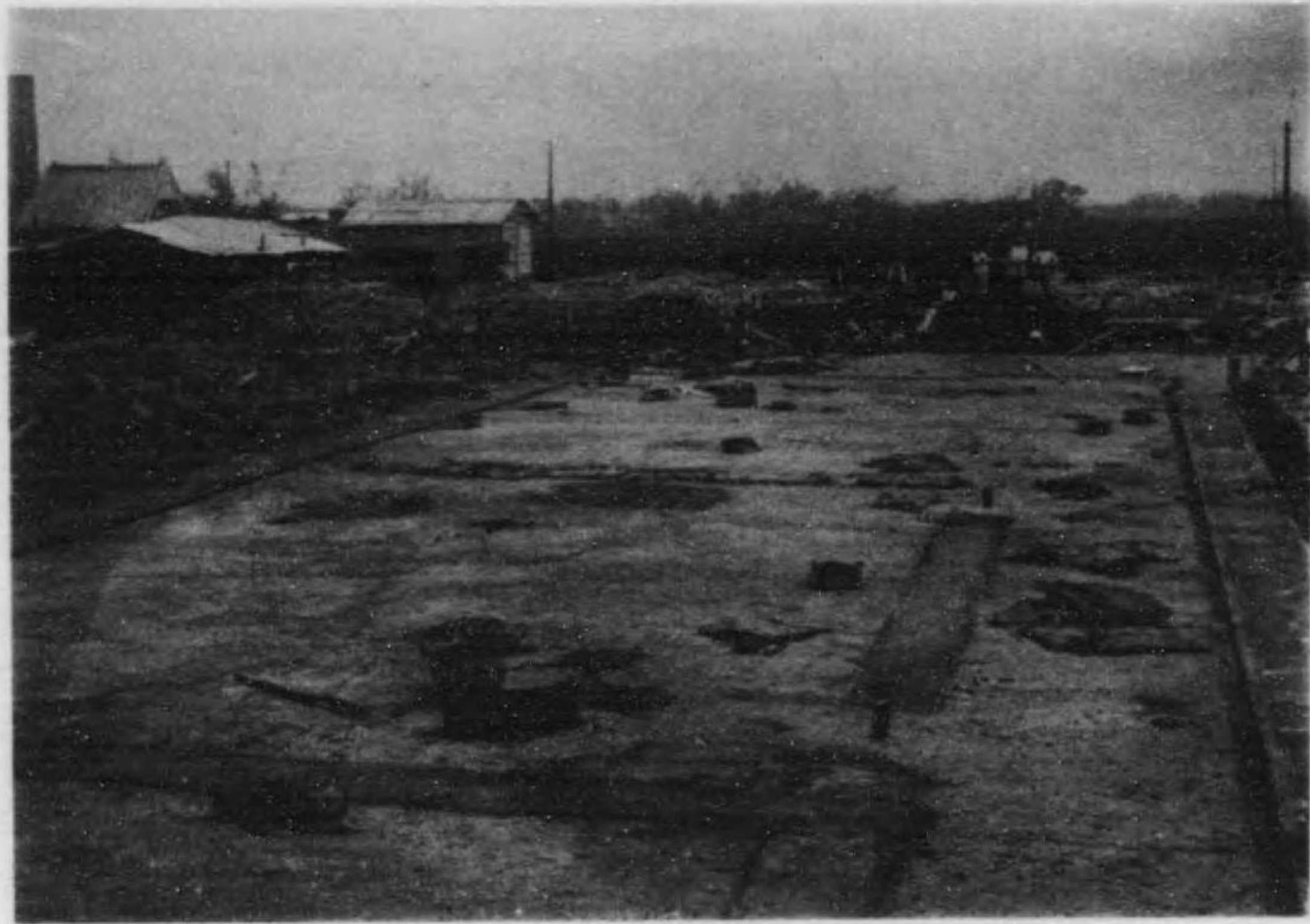
防蟻「コンクリート」工事完了ノ光景(温氣止メトシテ間仕切ノ下底ニ「アスファルト」ヲ塗リタル有様ヲ示ス)
