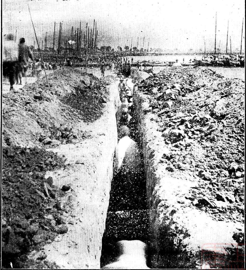
山東省建設廳設於河口黃河水底電纜施工情形 放綫前民夫在河岸挖溝將竣工時情形
