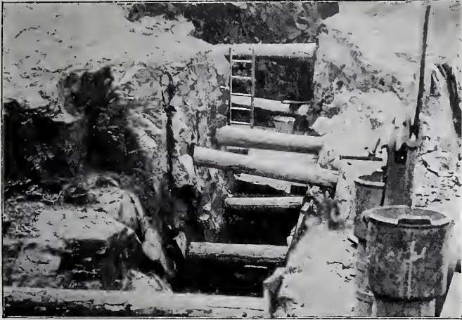
Abbildg. 7. Freilegung eines 6 m tiefen alten Stollenganges unter der Sohle des rechten Widerlagers.
