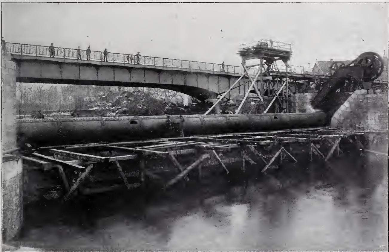
Abbildg. 1. Walzenverschluß des 35 m weiten Ueberfallwehres im Hauptarm des Mains. (Walze in niedrigster Stellung.)
