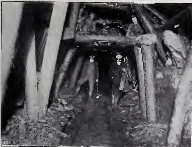
Abbildg. 2. Einbaustrecke mit stark drückendem Gebirge.
