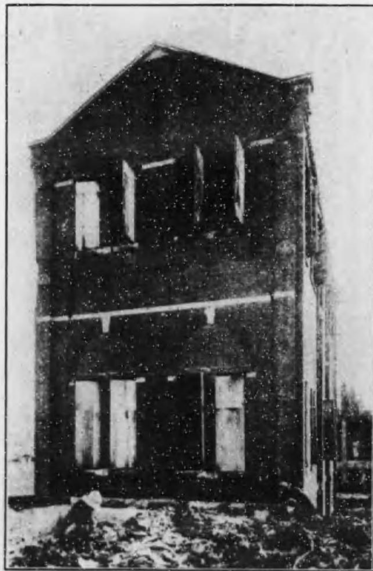
京橋變電所北妻被害
