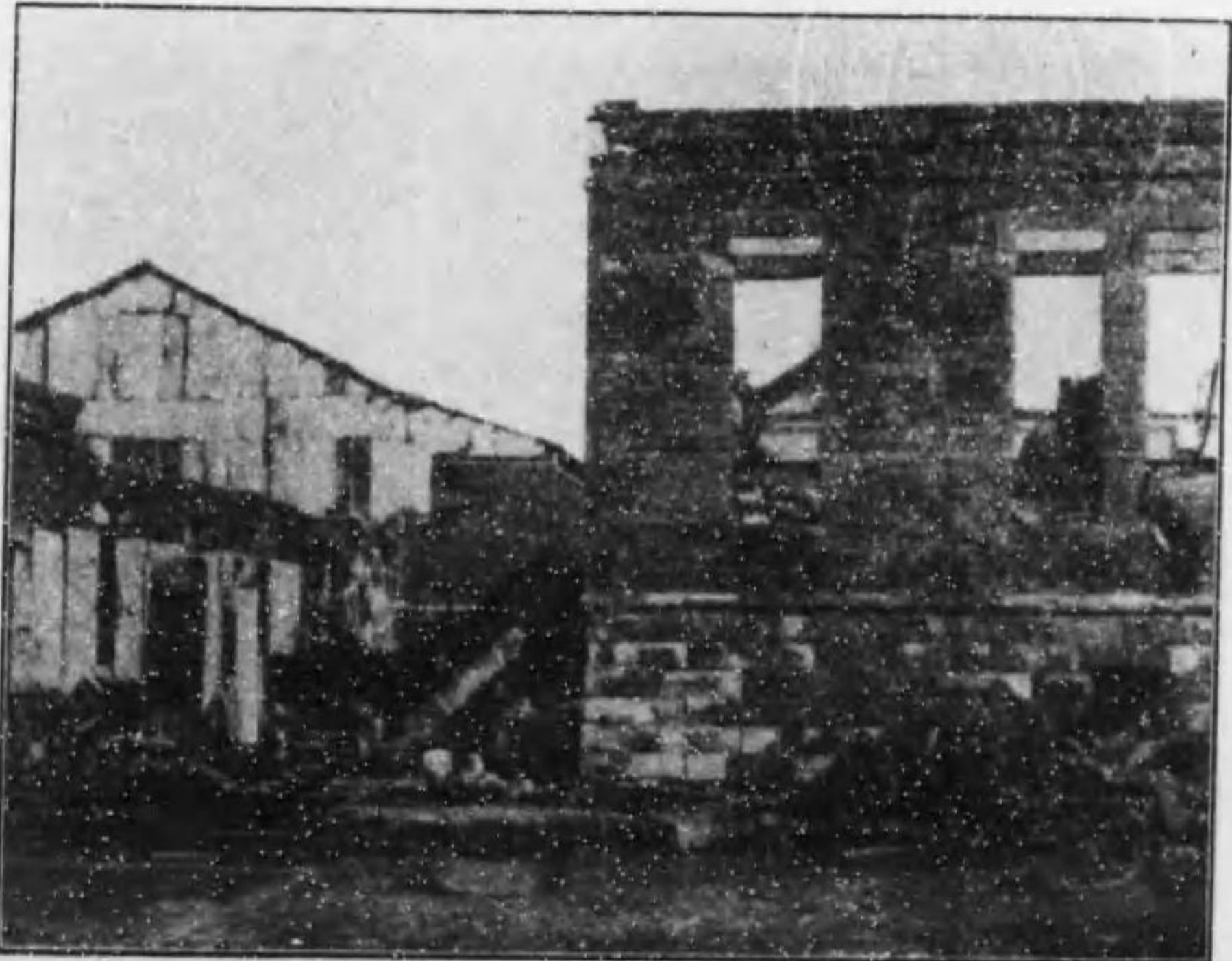
有樂町變壓所一部份の被害
