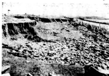
松江金山嘴海塘工程第一期完工者 險險塘之前修未後隔坍塌塘
