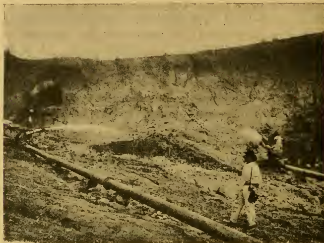
FIG. 11. — L'exploitation par la méthode hydraulique de la calotte de latérite aurifère du GISEMENT DE BETAIMBY (MANDRATY).
