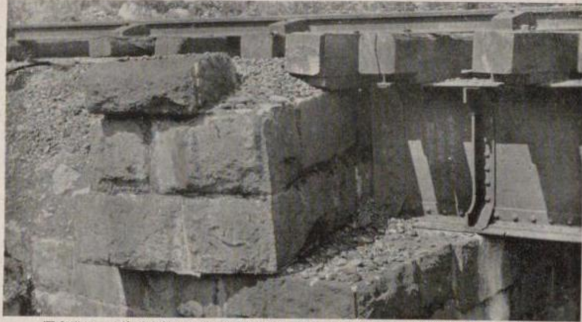
國有鐵道 東海道本線谷峨駿河間沙留起點 63 哩 64 鎮大深川橋梁駿河方橋臺の破壊
