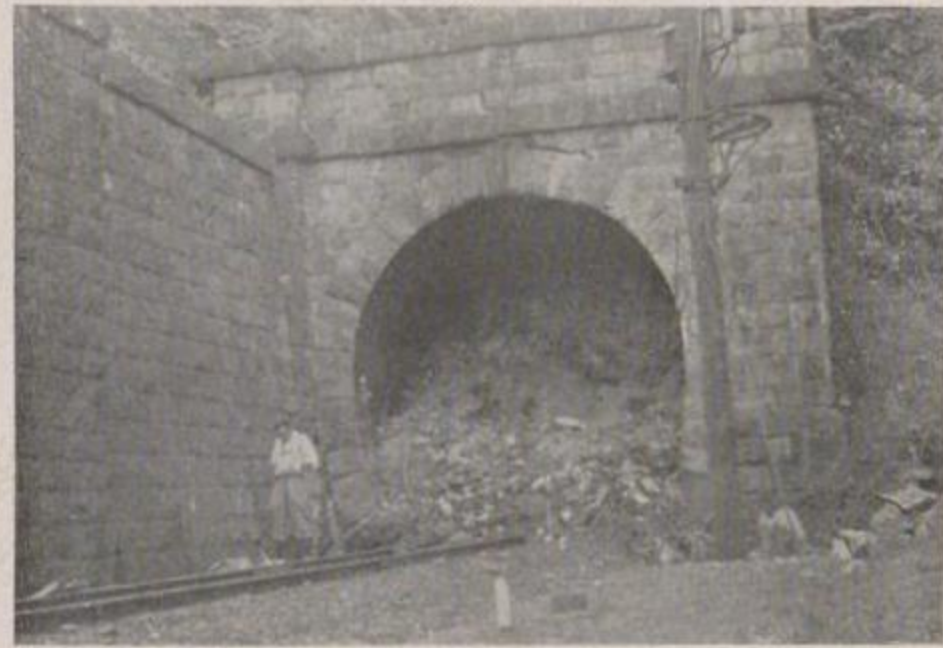
國有鐵道 東海道本線箱根第七號隧道上り線東京方坑門附近の被害
