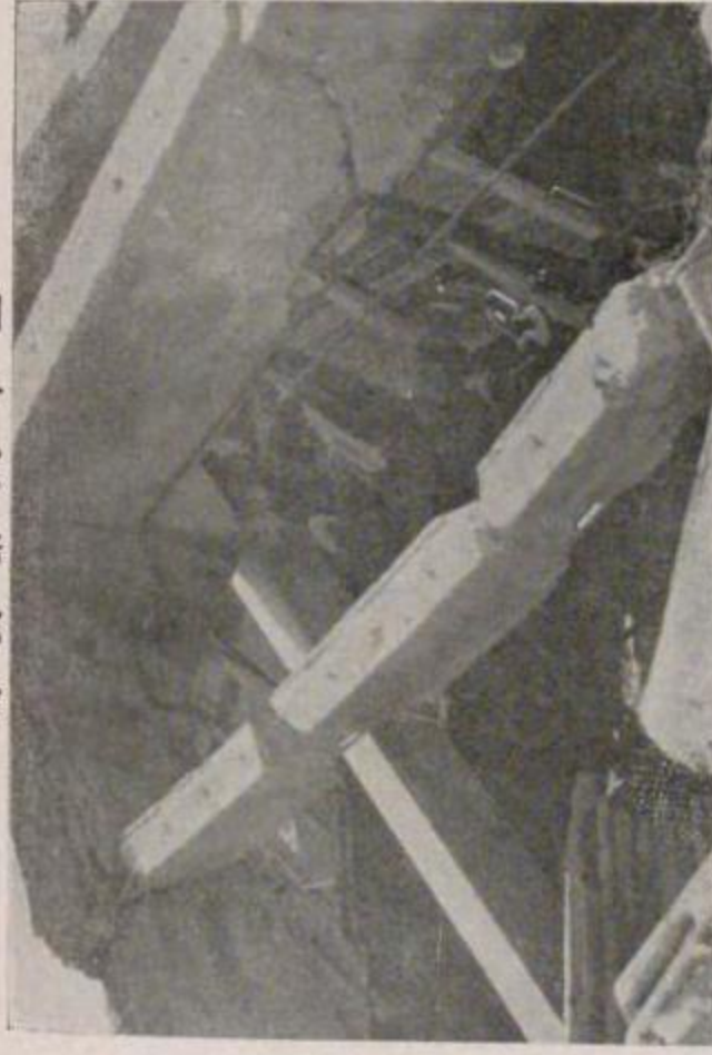
國有鐵道 東海道鶴見程ヶ谷間貨物支線高島驛海ホーム鐵筋混凝土上家の崩壊
