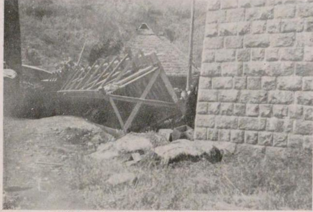
國有鐵道 熱海線早川根府川間玉川橋梁第四徑間下り線 60 呎飯桁の墜落
