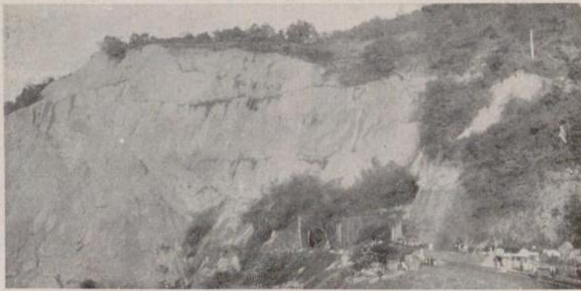
國有鐵道 東海道本線箱根第七號隧道沼津方坑門附近の山崩
