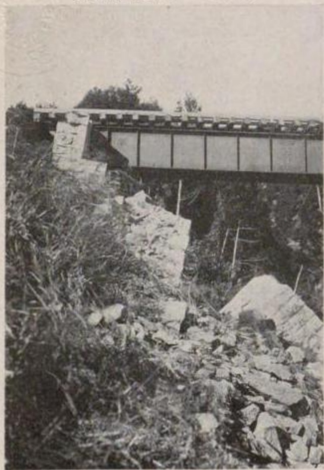
國有鐵道 熱海線根府川眞鶴間國府津起點 8 哩 70 鎖 45 節双龍ノ瀧橋梁の被害
