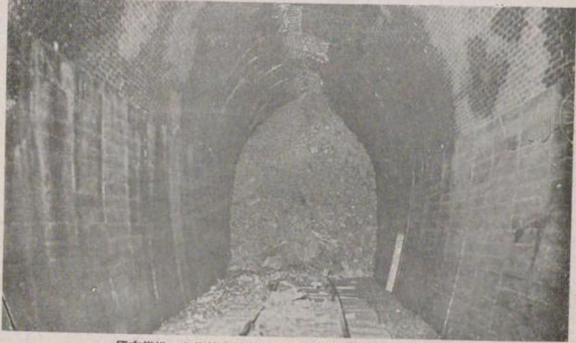
國有鐵道 北條線岩井富浦間南無谷隧道拱崩壞土砂の溢出
