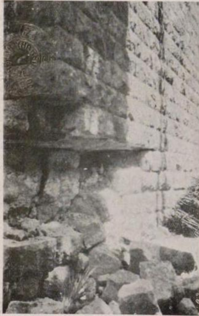
國有鐵道 熱海線早川根府川間玉川橋梁第五號橋脚の切斷滑動（海側より望む）
