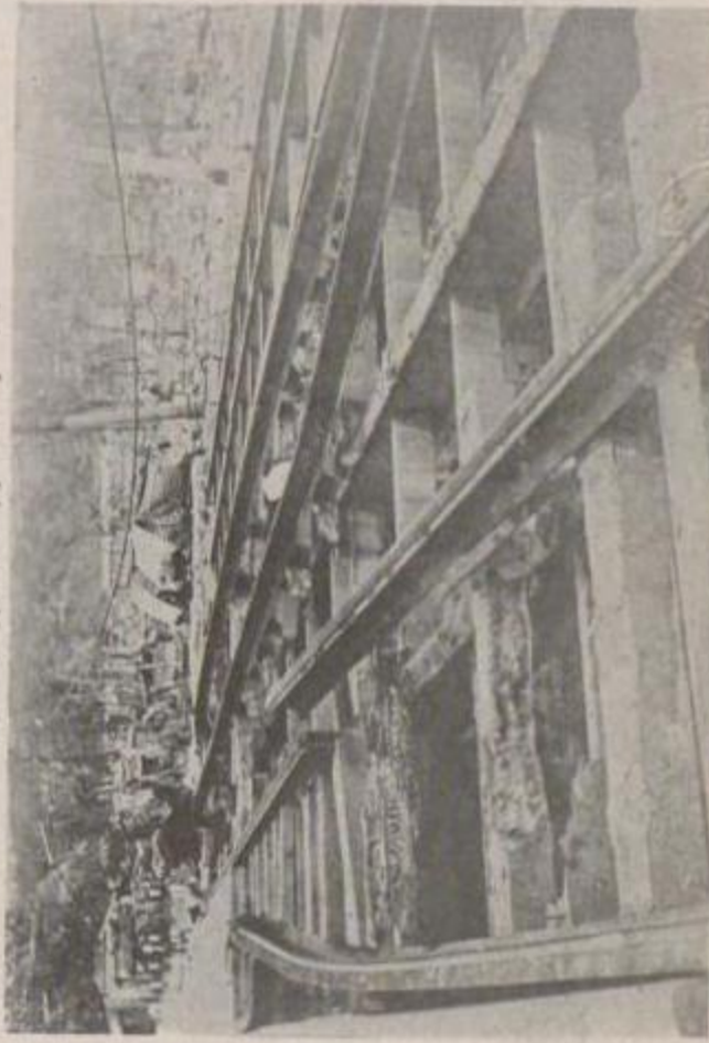
横濱市營電氣軌道 榮橋橋上軌道の被害
