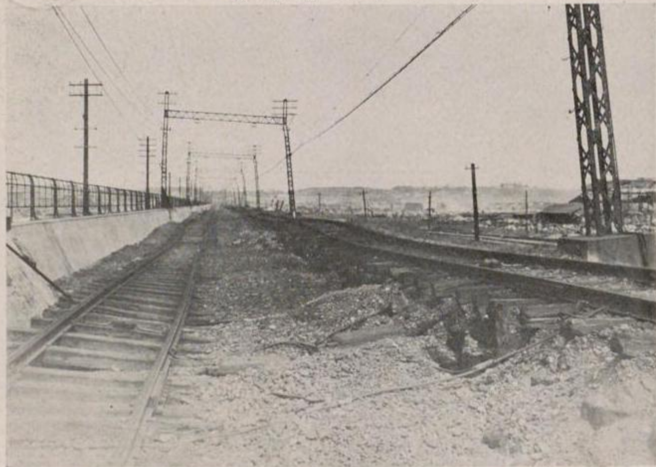
國有鐵道 東海道横濱櫻木町間電車線高架軌道着盤陥落及び土留壁の傾斜
