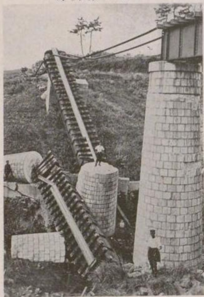
國有鐵道 北條線九重千倉間第一瀬戸川橋梁第一號橋脚の切斷願倒を江見方より望む
