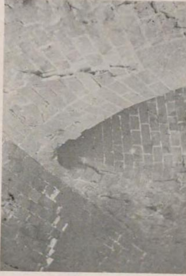
國有鐵道 東海道本線有樂町驛附近高架線煉瓦石拱内部の燒損陥落
