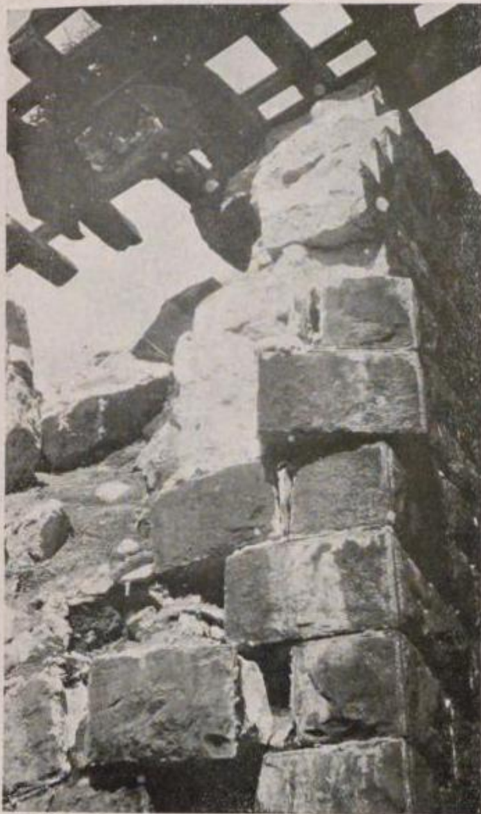
國有鐵道 東海道本線駿河足柄間汐留起點 66 哩 14 節 60 節 第三入山澤開渠橋臺の破壊(其三)(徑間 10 呎)
