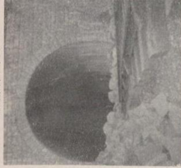
國有鐵道 熱海線根府川眞鶴間江浦隧熱海 方坑門の被害
