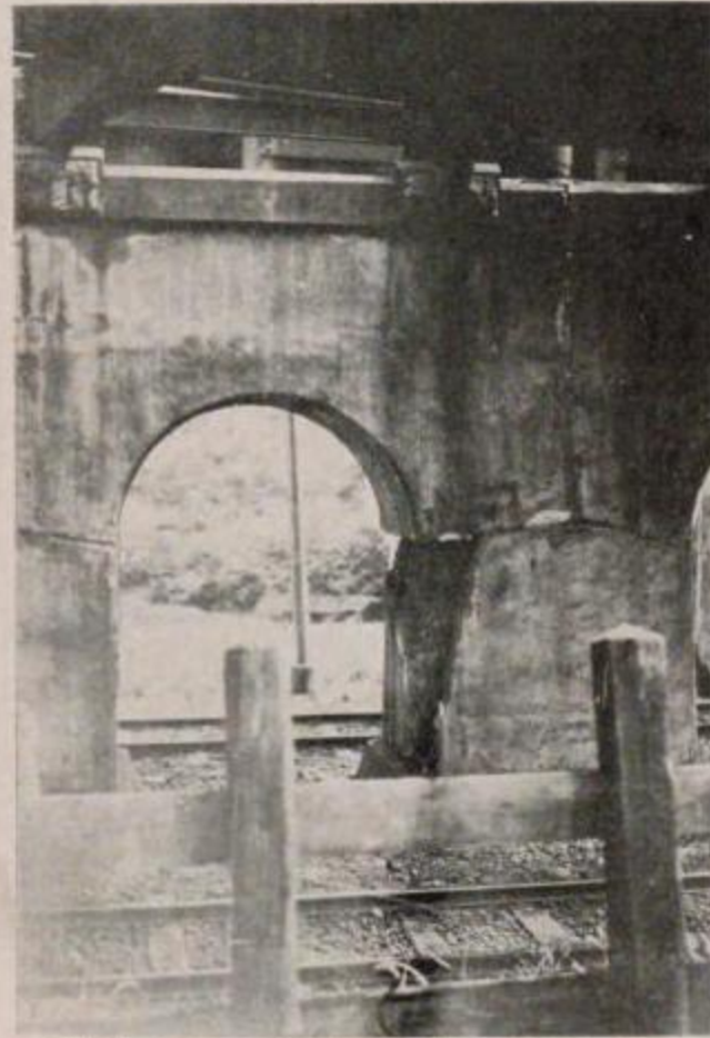
國有鐵道 目黒恵比壽間汽車線乗越橋梁混凝土橋脚の龜裂
