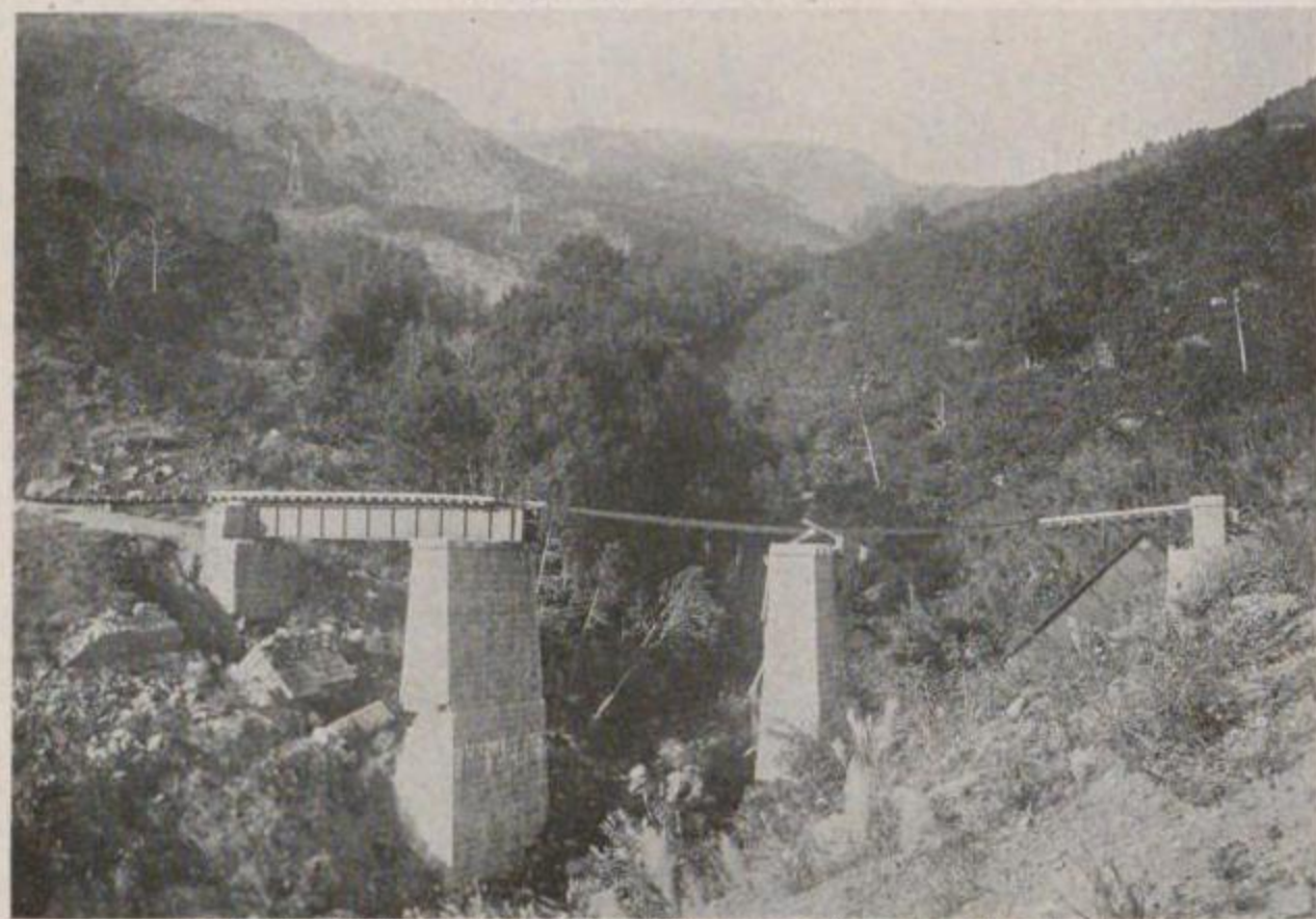
國有鐵道 熱海線根府川眞鶴間國府津起點 8 哩 70 鎖 45 節双龍ノ瀧橋梁の被害
