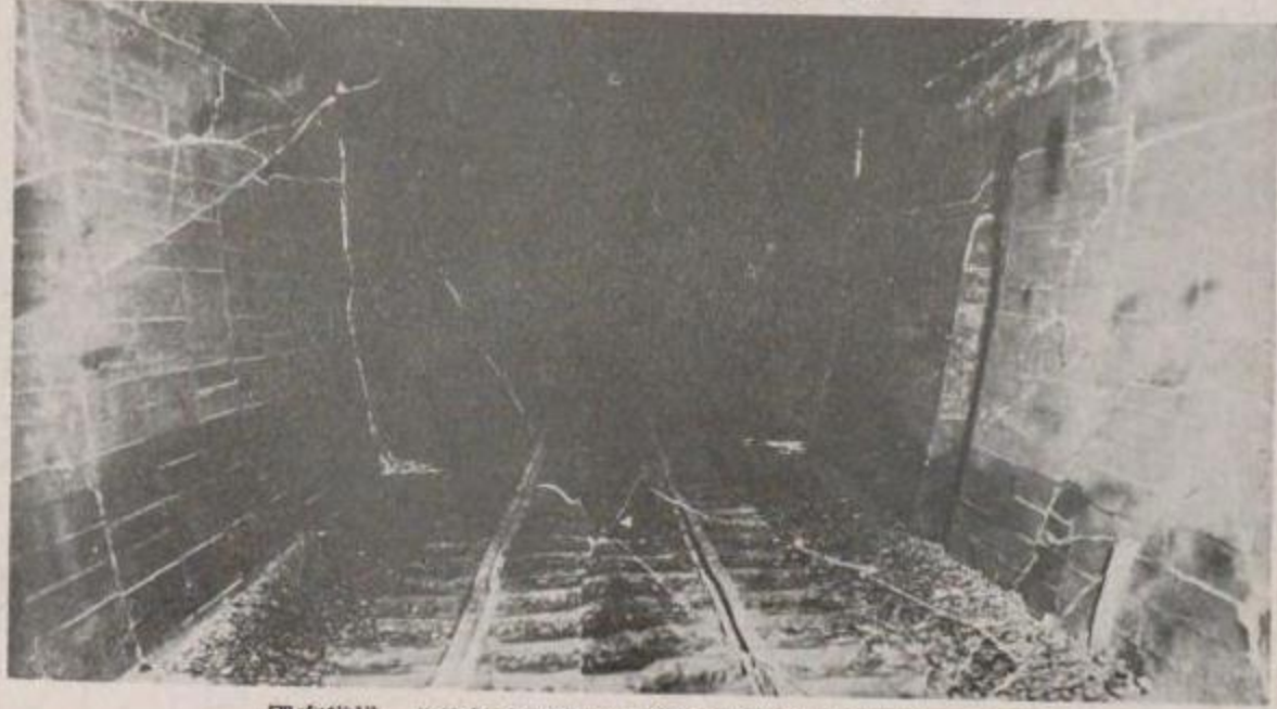
國有鐵道 北條線岩井富浦間南無谷隧道拱及び側壁の大龜裂
