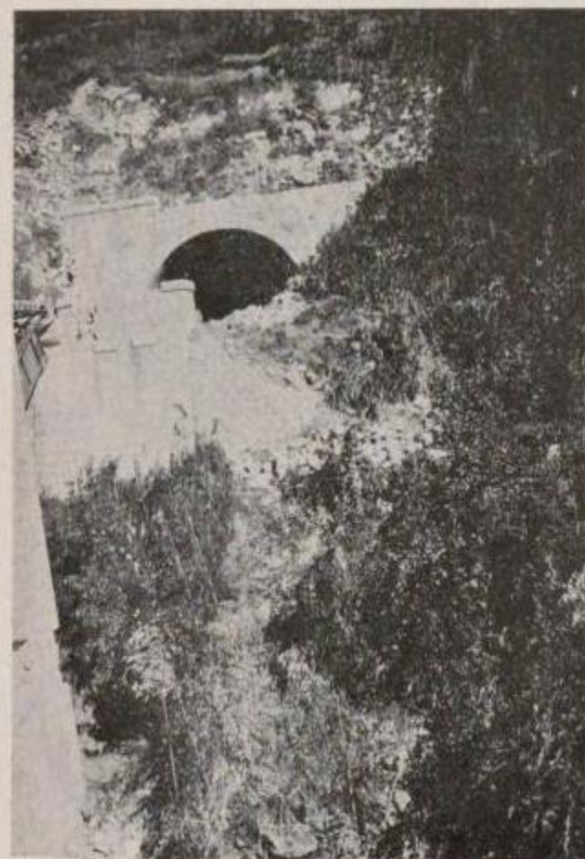
國有鐵道 熱海線根府川眞鶴間國府津起點 8 哩 70 鎖 45 節双龍ノ瀧橋梁の被害
