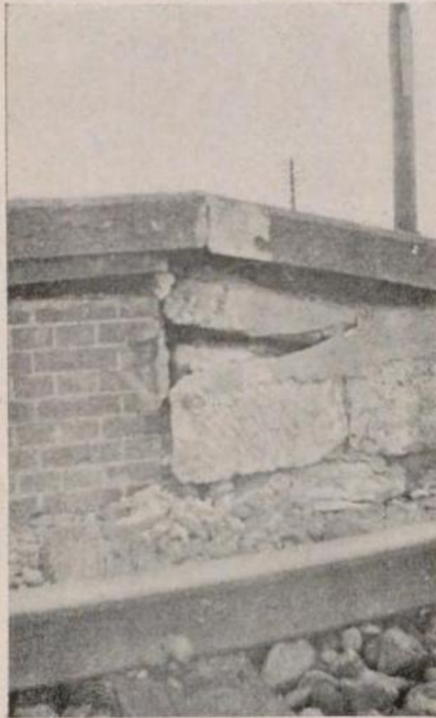
國有鐵道 山手線板橋驛乘降場擁壁と損橋面壁との接合部の隆起
