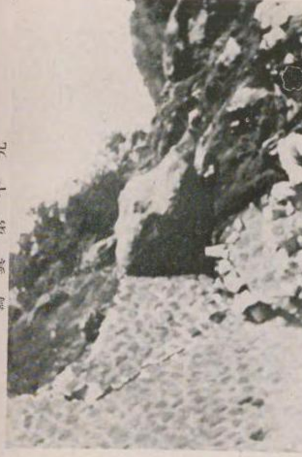
國有鐵道 東海道本線松田山北間砂留起點 56 哩 60 頓附近切取法留石 垣の崩壞
