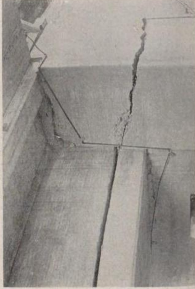
國有鐵道 熱海線早川驛地下道擁壁の龜裂
