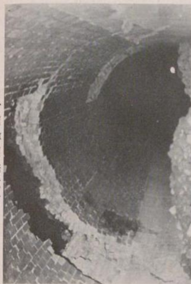
國有鐵道 熱海線根府川真鶴間國府津起點 9哩 55 鎮 0 節長坂山隧道熱海方坑門より約 300 呎附近に於て墜落せし磚狀石散
