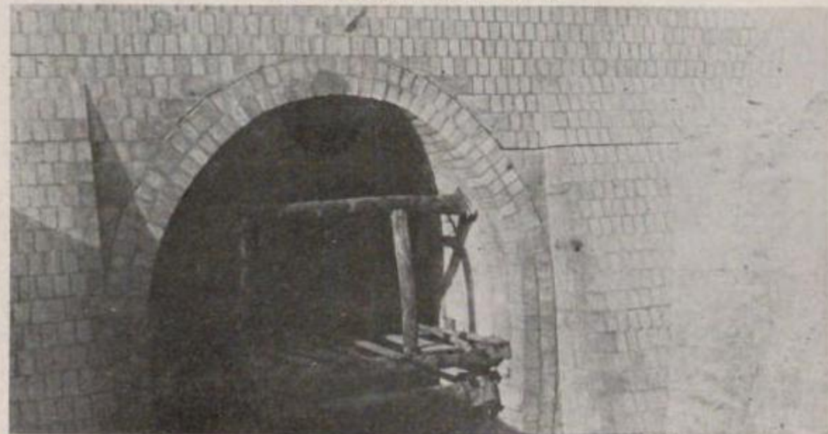
國有鐵道 安房線嶺岡山隧道北條方坑門の磚裂
