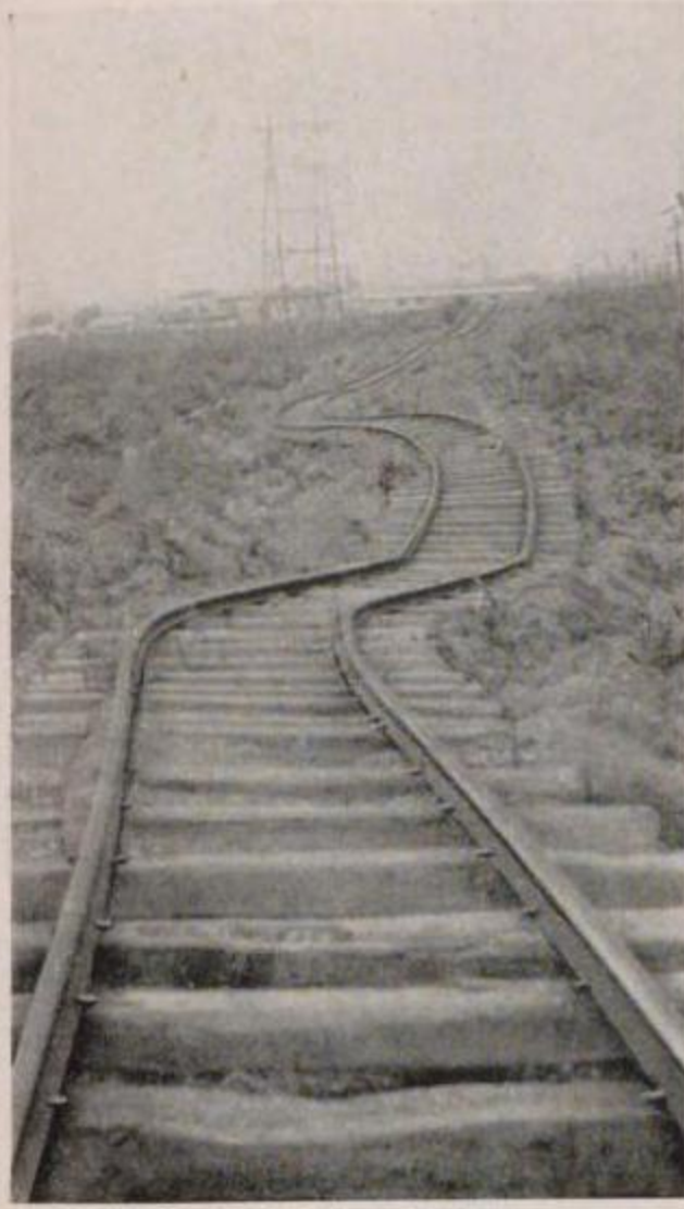
國有鐵道 東海道濱川崎支線 (淺野セメント株式會社引込線) 築堤盛土の沈下
