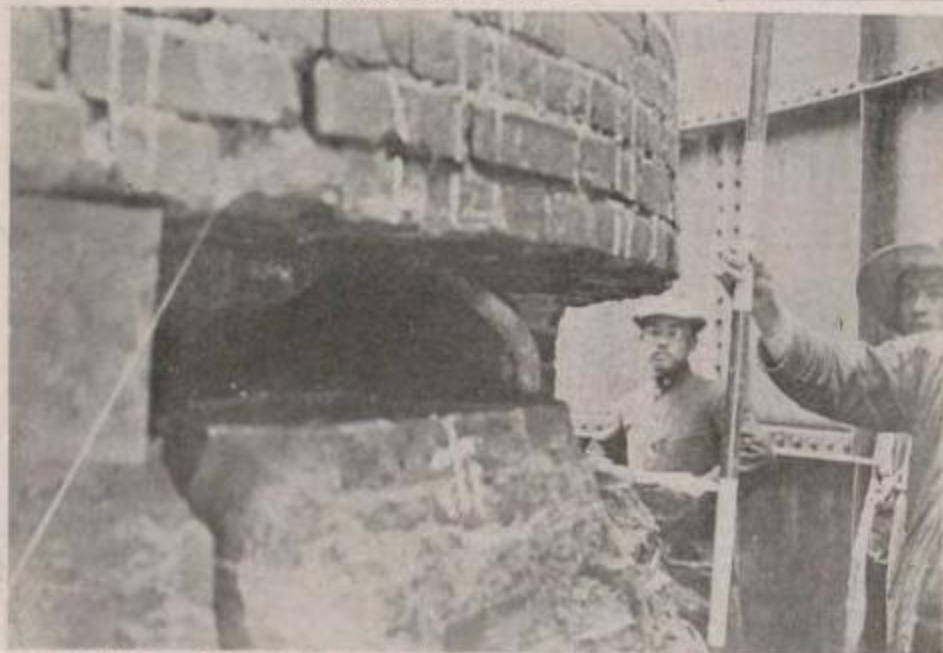
國有鐵道 東海道本線六郷川橋梁第二十六號川下方橋脚用井筒破損の狀態 (其二)
