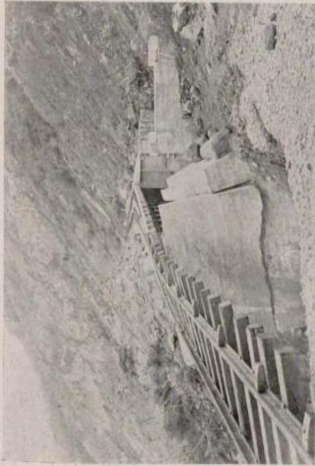
國有鐵道 熱海線根府川真鶴間國府津起點9哩6釐品瀬ノ瀬橋梁より切取の崩壊を望む(長坂山方面に向て撮影)
