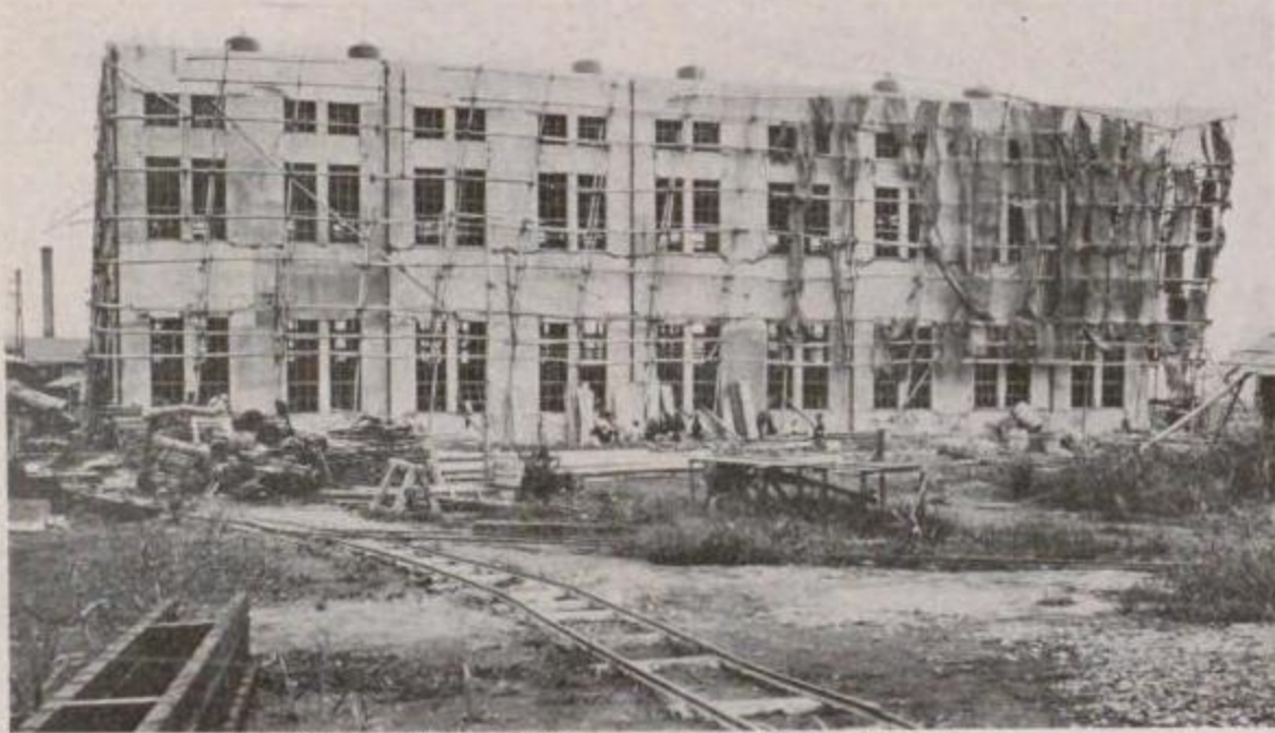
國有鐵道 電化工事に於ける川崎變電所建物の被害(其一)
