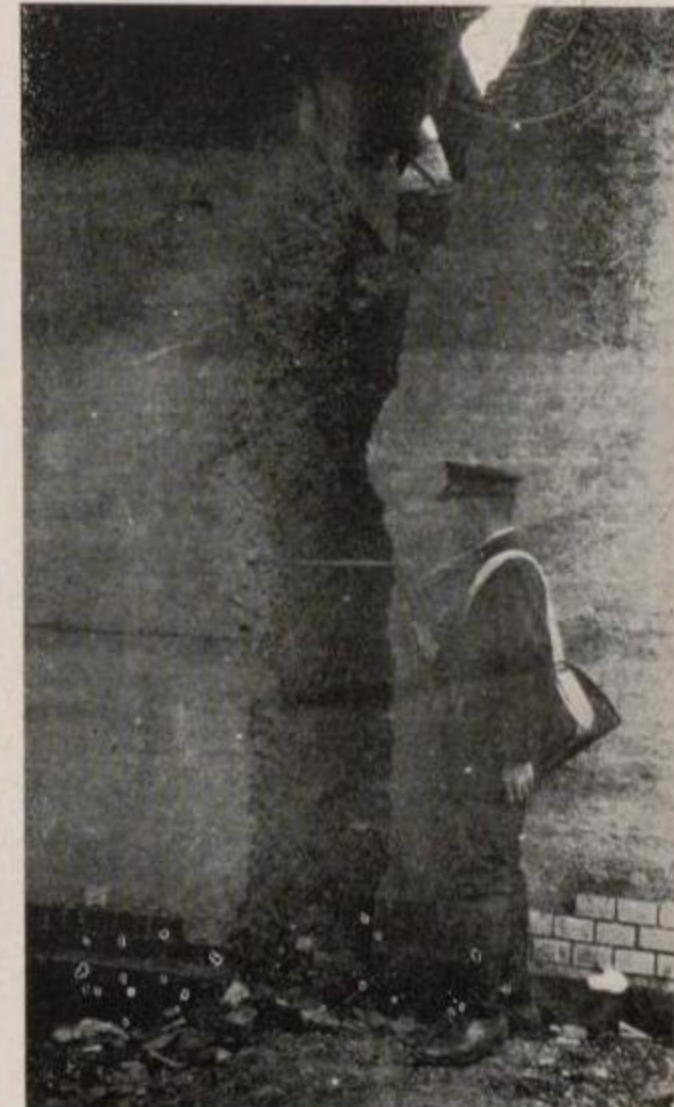
國有鐵道 東海道横濱櫻木町間電車線櫻木町驛地下道の破壊（其三）
