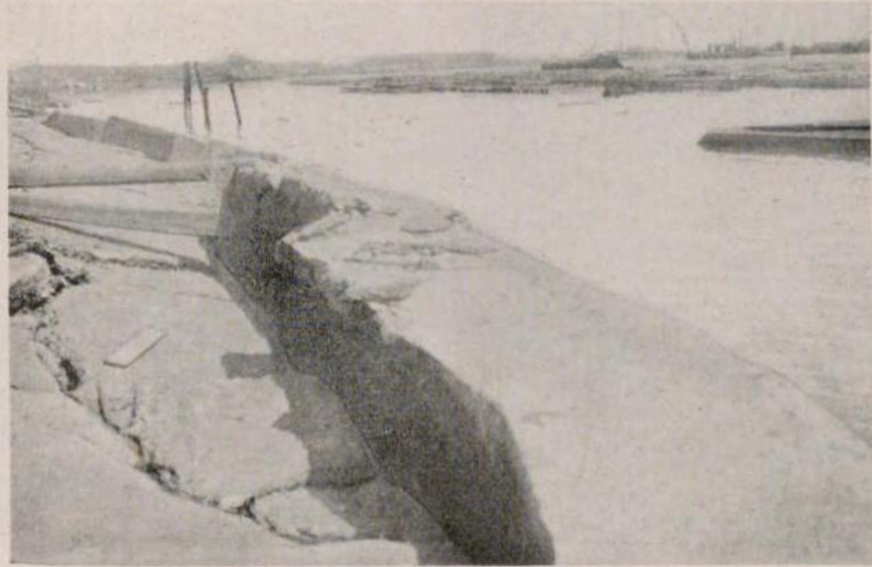
國有鐵道 東海道鶴見程ヶ谷間貨物支線横濱倉庫岸壁裏に生じたる龜裂
