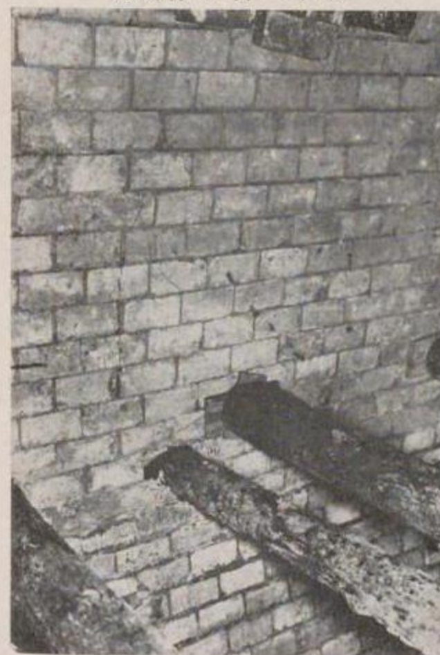
國有鐵道 安房線嶺岡山隧道蘇我起點72哩58鎖附近に於ける側壁の被害(支保工が側壁に喰ひ込める有様を示す)
