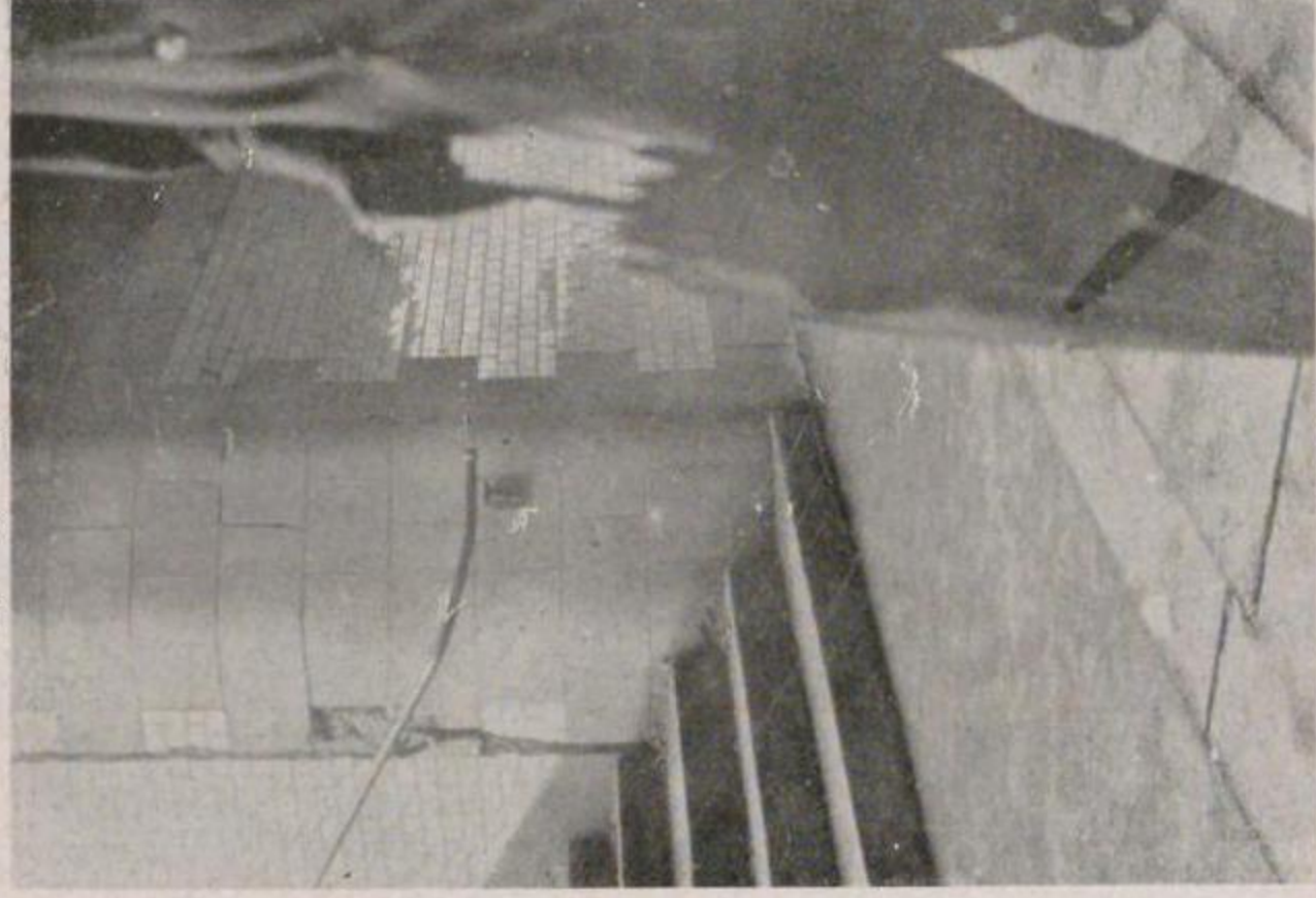
國有鐵道 横須賀線鎌倉駅地下道の龜裂(其一)
