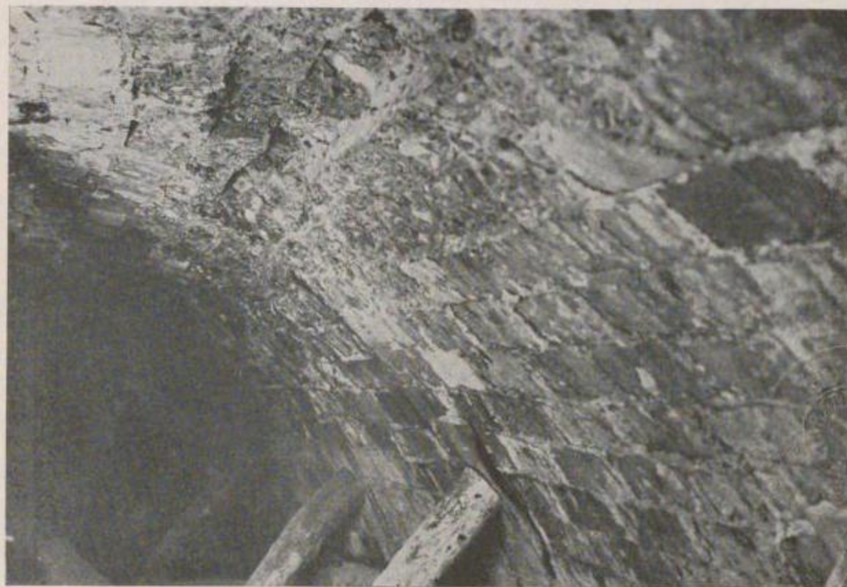
國有鐵道 安房線嶺岡山隧道蘇我起點72哩58鎖附近に於ける穹拱の被害
