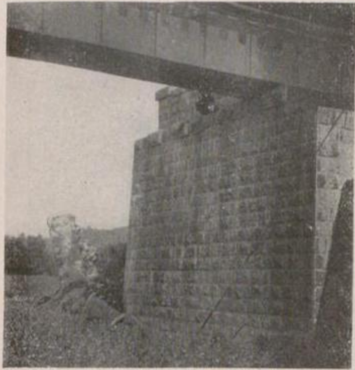
國有鐵道 熱海線早川根府川間早川橋梁國府津方橋臺袖石垣の破壊
