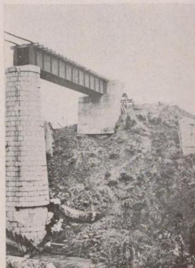
國有鐵道 北條線九重千倉間第一瀬戸川橋梁江見方橋臺及び第二號橋脚の被害(千葉方より望む)
