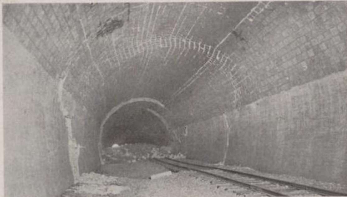
國有鐵道 熱海線根府川真鶴間國府津起點 9哩 55 鎮 0 節長坂山隧道坑内の被害(國府津方を望む)
