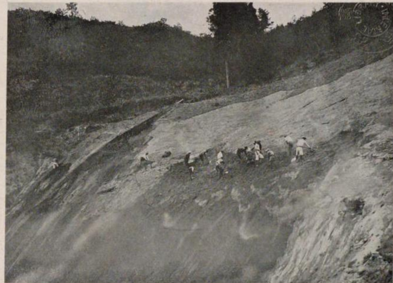
國有鐵道 北條線上總湊濱金谷間天神山隧道江見方坑門附近切取法崩壊
