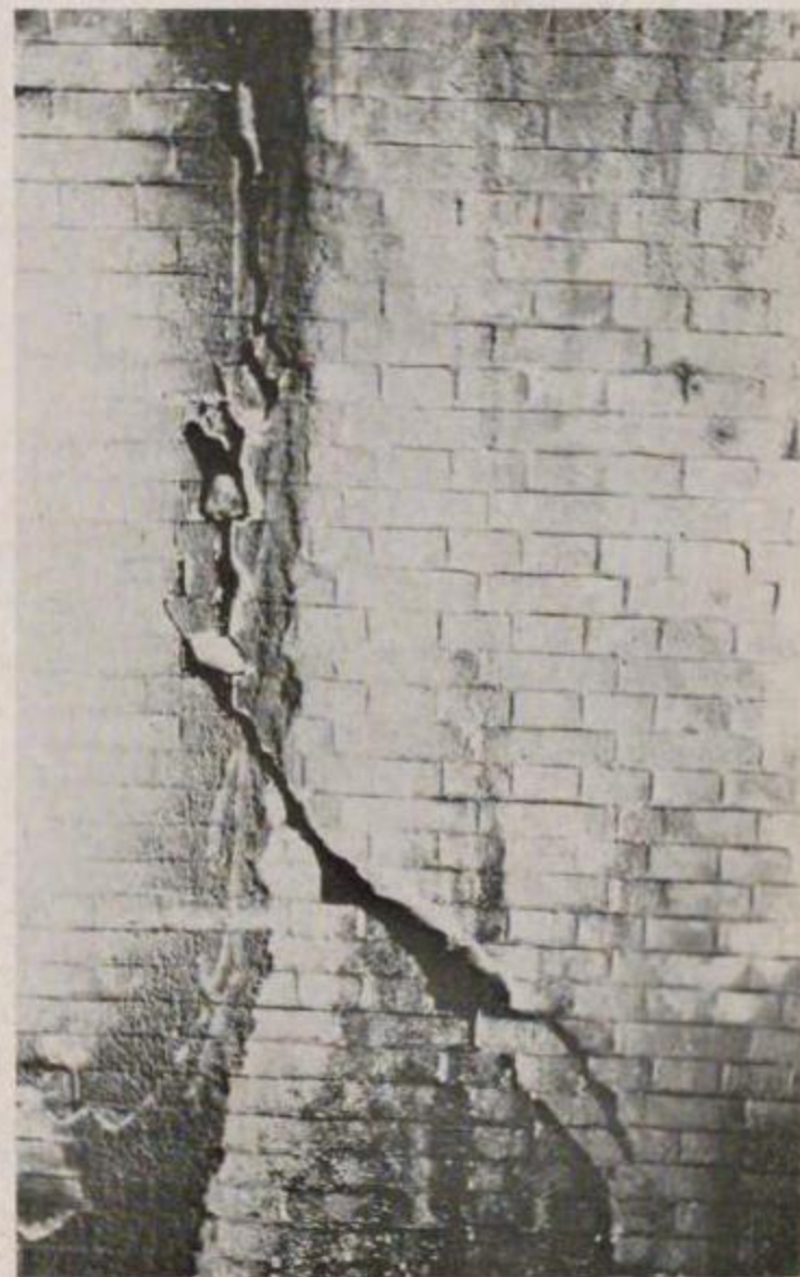
國有鐵道 東海道本線山北谷峨間箱根第二號隧道上り線 東京方坑門より 10 呎の奥に生じたる龜裂
