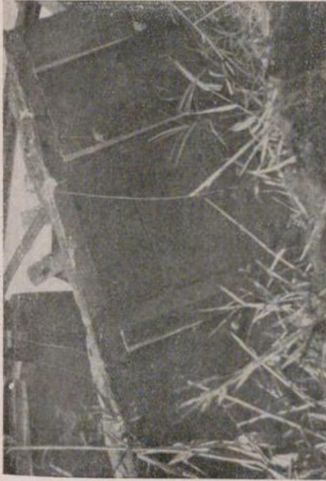
國有鐵道 東海道本線茅ヶ崎平塚間馬入川橋梁下り線第二十號橋脚、脚上に床鐵附着せるまゝ倒壊せるを示す
