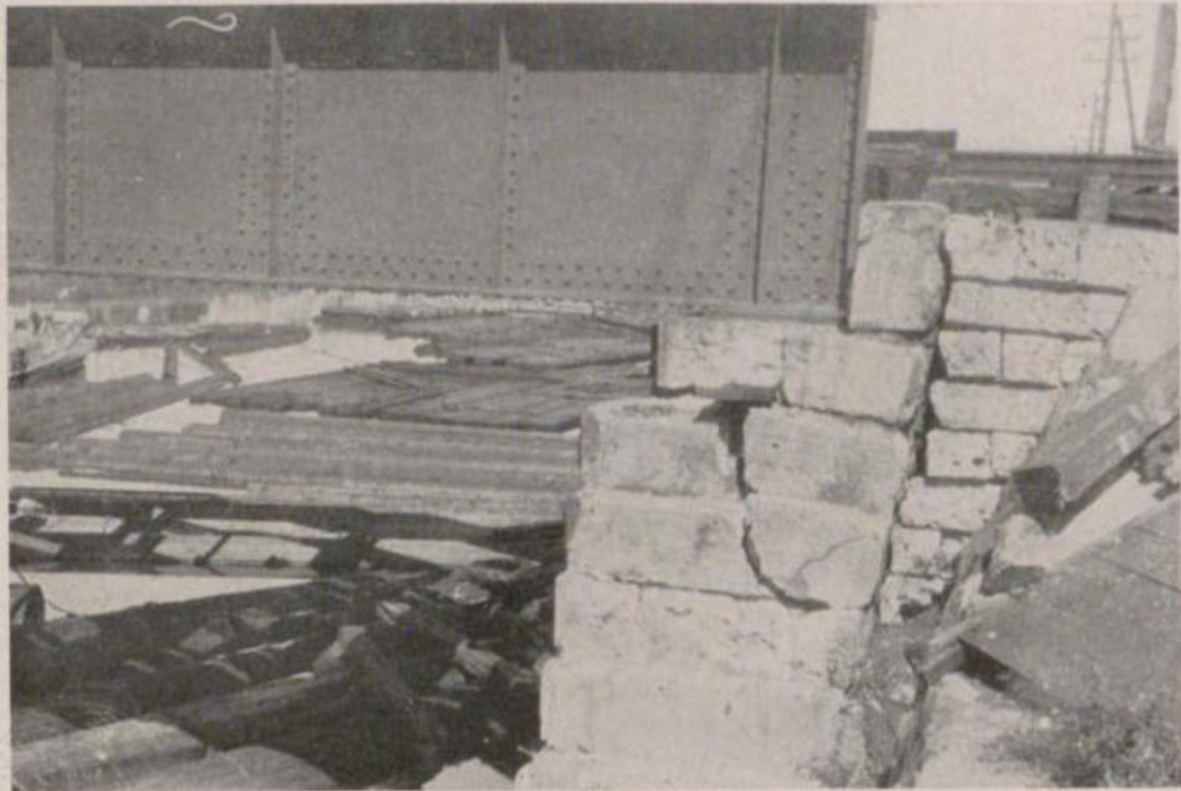
國有鐵道 東海道東神奈川神奈川間貨物支線第二運河橋梁東橋臺（海側）の龜裂（徑間 40 呎飯桁）
