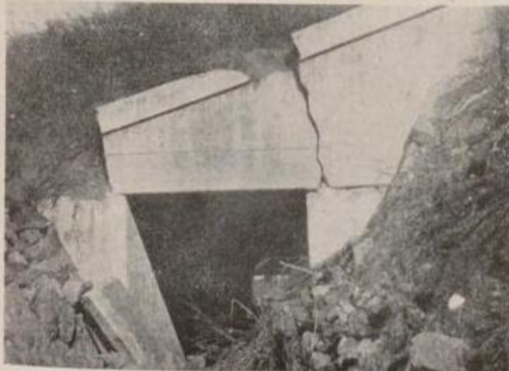
國有鐵道 熱海線早川根府川間入ノ窪暗渠山側側面の龜裂
