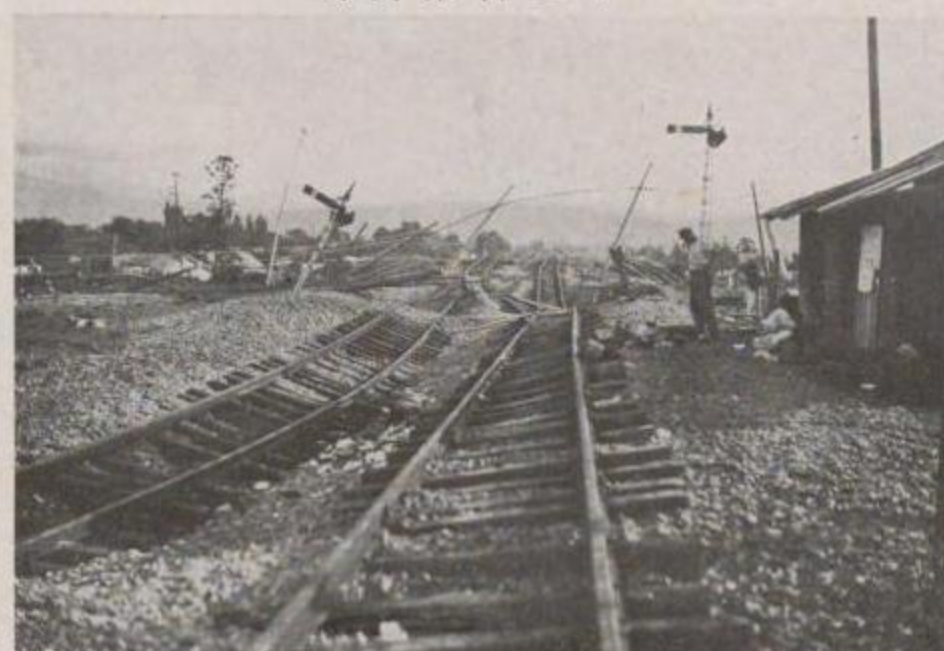
國有鐵道 熱海線小田原驛鴨宮方より見たる線路の破壊
