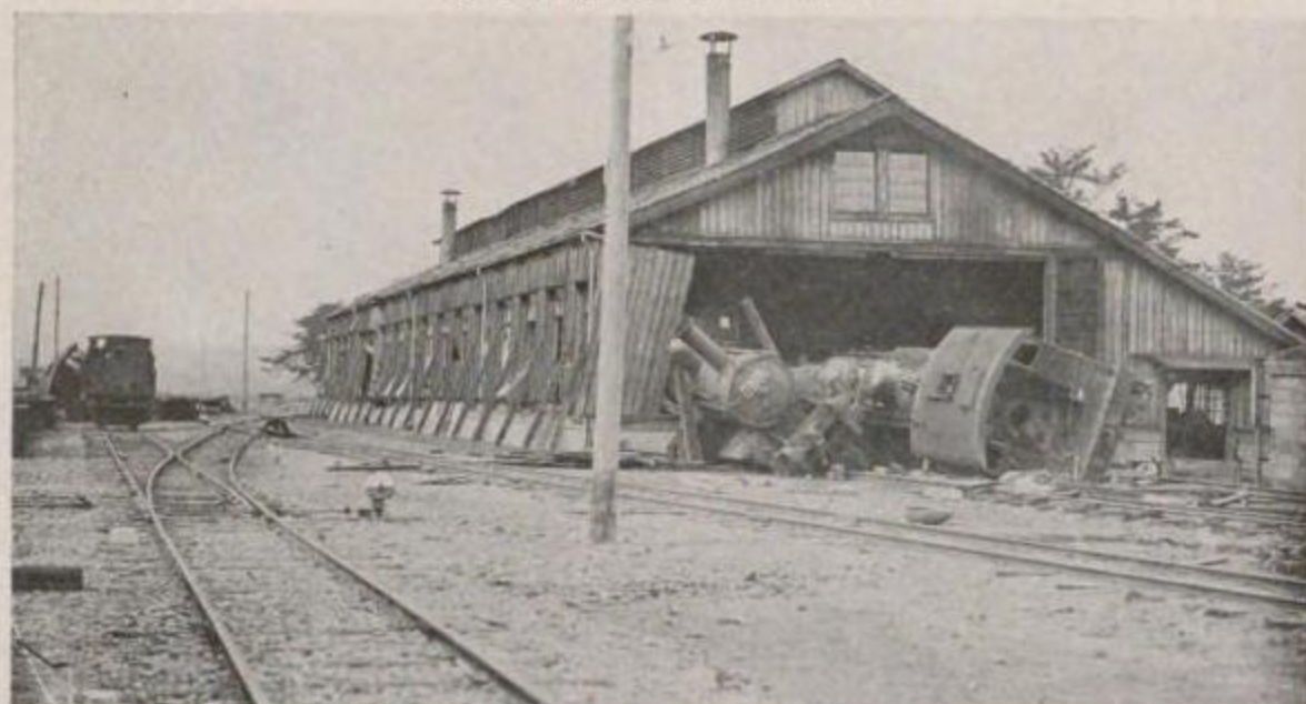
國有鐵道 北條線安房北條驛機關車庫の傾斜並に機關車の顛覆
