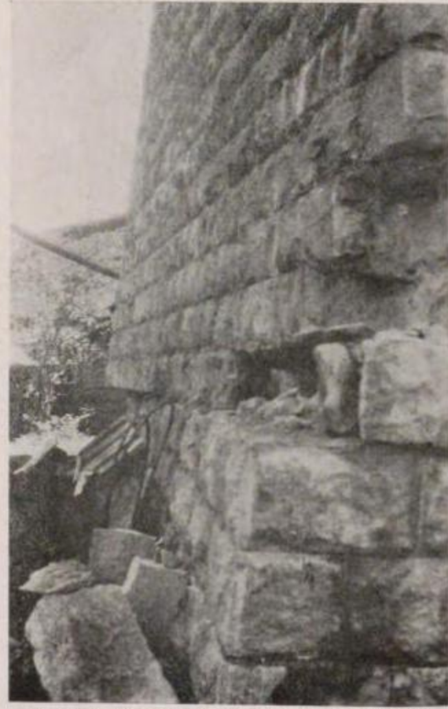
國有鐵道 熱海線早川根府川間玉川橋梁第六號橋脚下部の切斷滑動（山側より望む）
