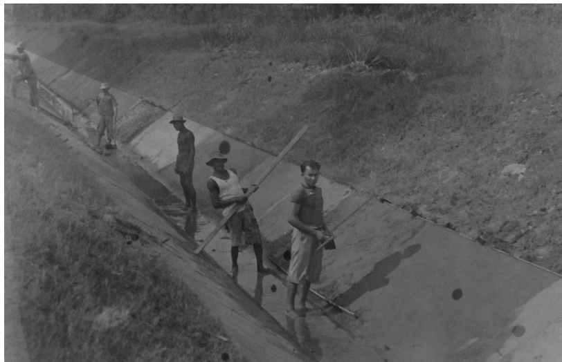
Figura 1. Reparos da vala de drenagem, em Quintino Bocaiuva. Obras de manutenção do dique de Belém. Dezembro, 1945.
