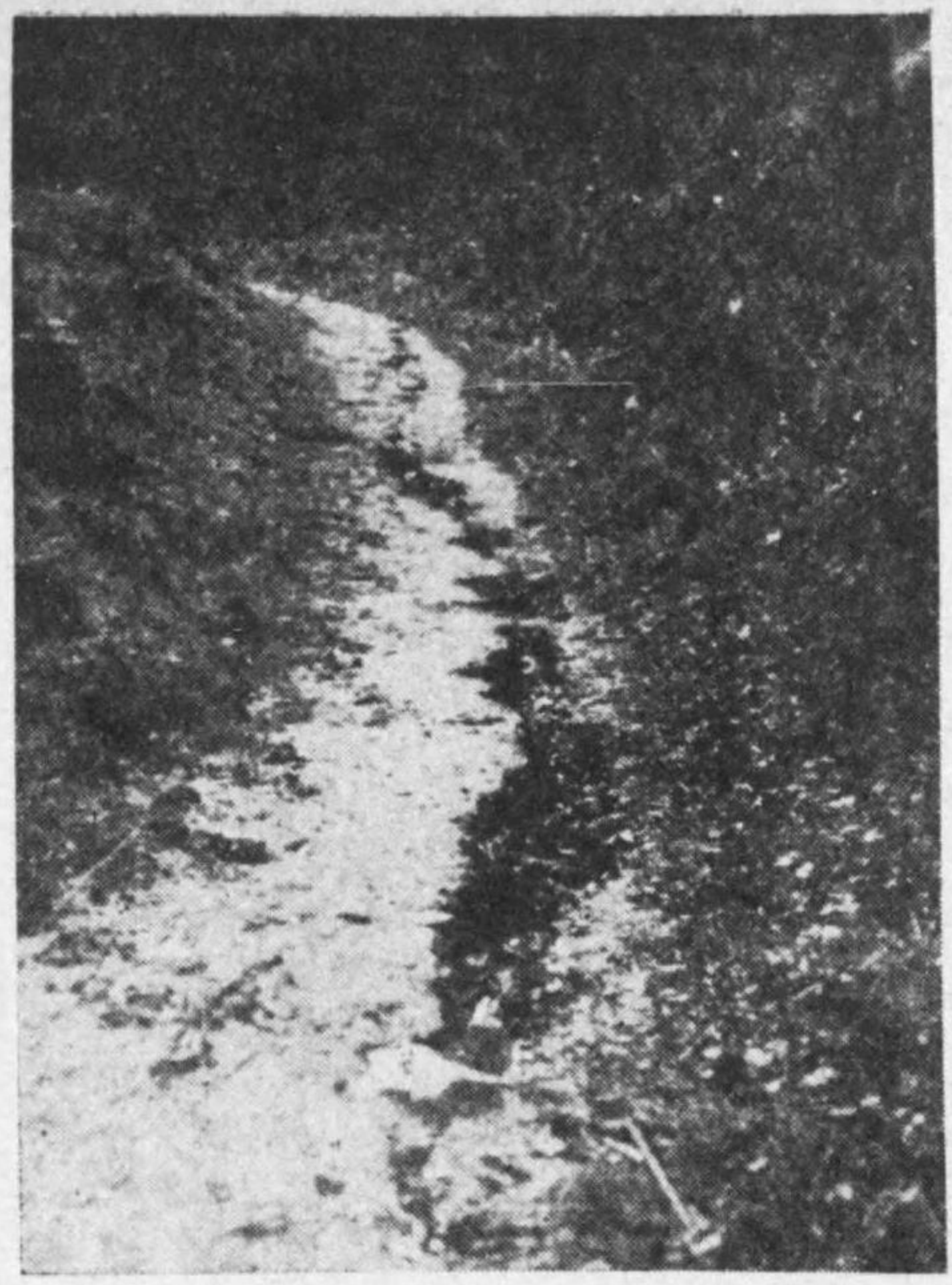
道路の龜裂 (土澤部落附近)
