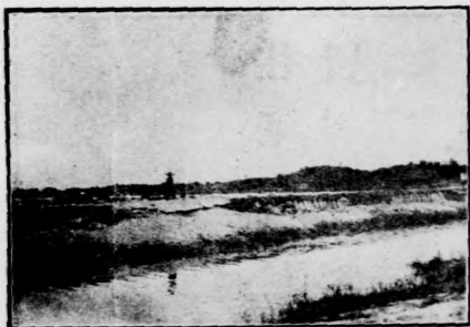
麻界段白塔河蠻石堤路 被沖後情形
