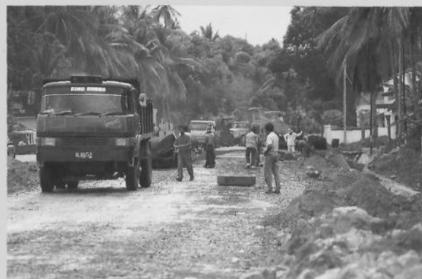
Perbaikan jalan provinsi di Aceh Besar. Rehabilitation of provincial road in Aceh Besar.
