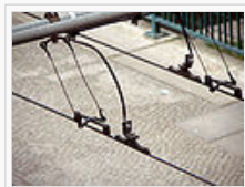
Eberswalde: Stromzuführung am Speisepunkt im Detail
