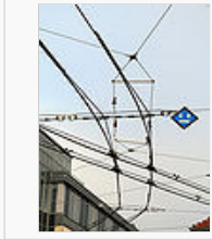
St 3: Ankündigung einer Fahrleitungsunterbrechung in Folge einer Kreuzung
