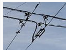
Trennung zweier Speisebereiche mittels kurzer Plastikschiene, Einspeisung kurz vor und nach dem Trenner
