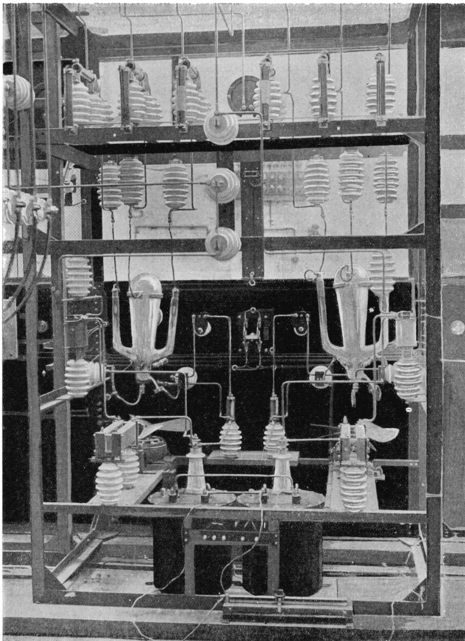
Выпрямительное устройство высокого напряжения системы В. Володина уст. на Московской Октябрьской Радиостанции. Мощн. выпрям. тока 40 кВт, 12.000 V.
