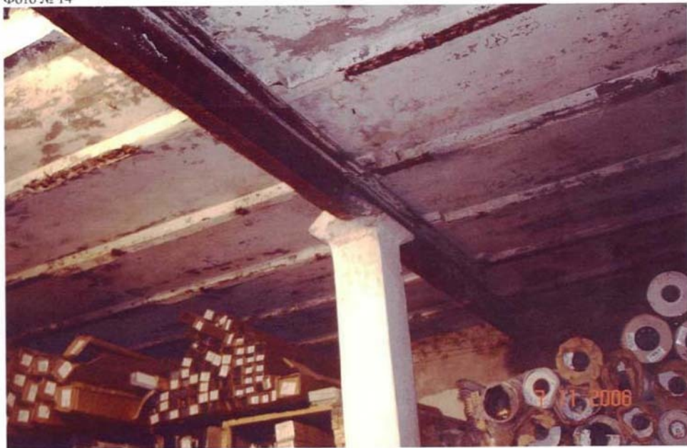
г. Хабаровск, ул. Кавказская, 35 Рефрижератор, 1913г., 1925г., 1928 г.. Интерьер холодильной камеры.
