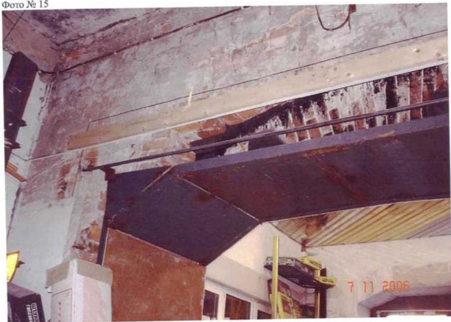
г. Хабаровск, ул. Кавказская, 35 Рефрижератор, 1913г., 1925г., 1928 г.. Интерьер холодильной камеры.
