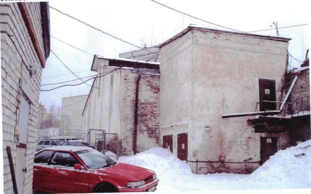
г. Хабаровск, ул. Кавказская, 35 Рефрижератор, 1913г., 1925г., 1928 г.. Юго-западный фасад, левая часть.
