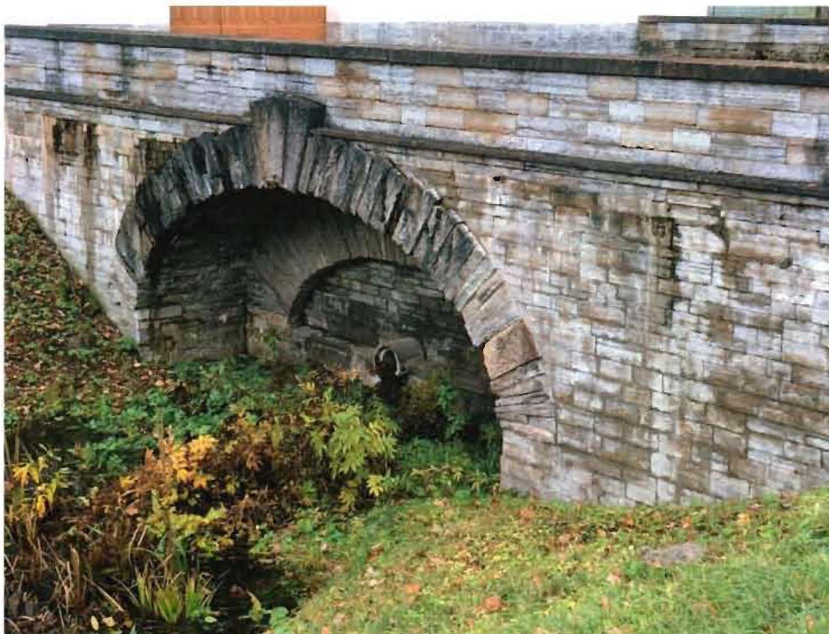
Фото № 2. Вид на арочный свод объекта культурного наследия (следы намокания, очаги биопоражения).
