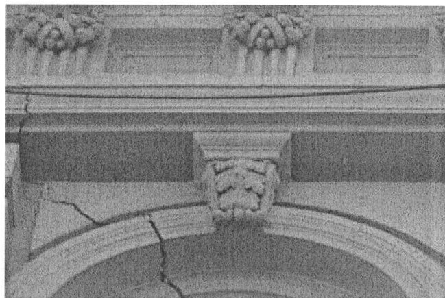
Замковые камни окон третьего этажа с лепными декором в виде листьев аканта
