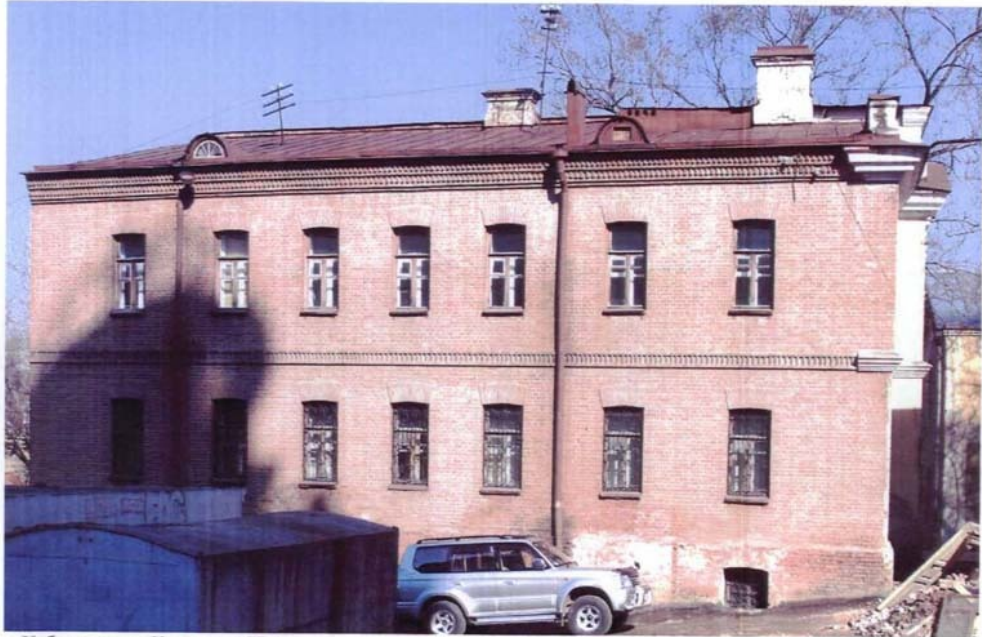
г. Хабаровск, ул. Калинина, 77 А Дом доходный Г.Н. Пырского, до 1914 г. Юго-восточный фасад.
