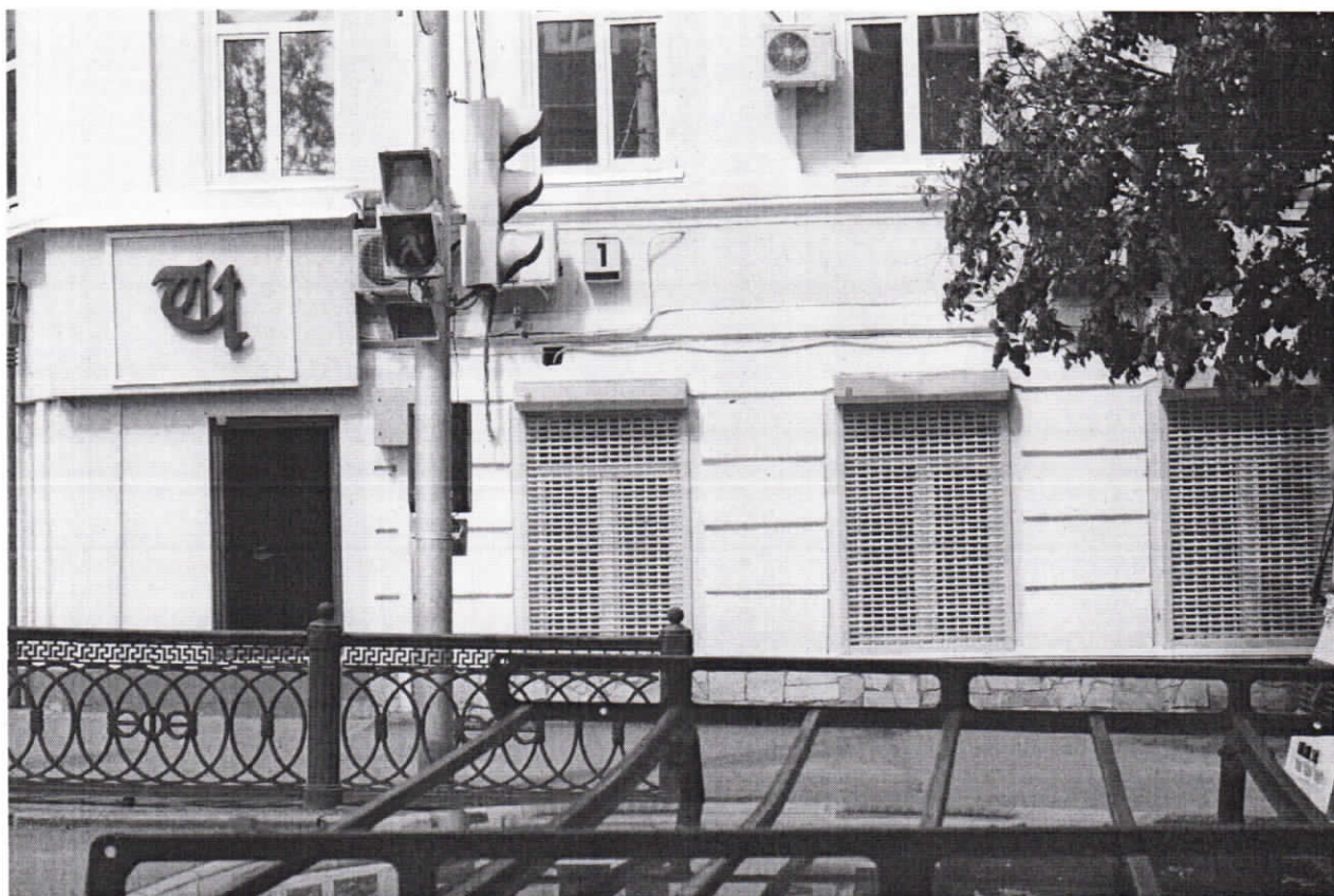
Фото 10. Фрагмент южного лицевого фасада. Междуэтажный пояс первого и второго этажей; прямоугольные оконные проемы первого этажа; лучковые оконные проемы второго этажа. Дата фотографии 15 июня 2018 года.
