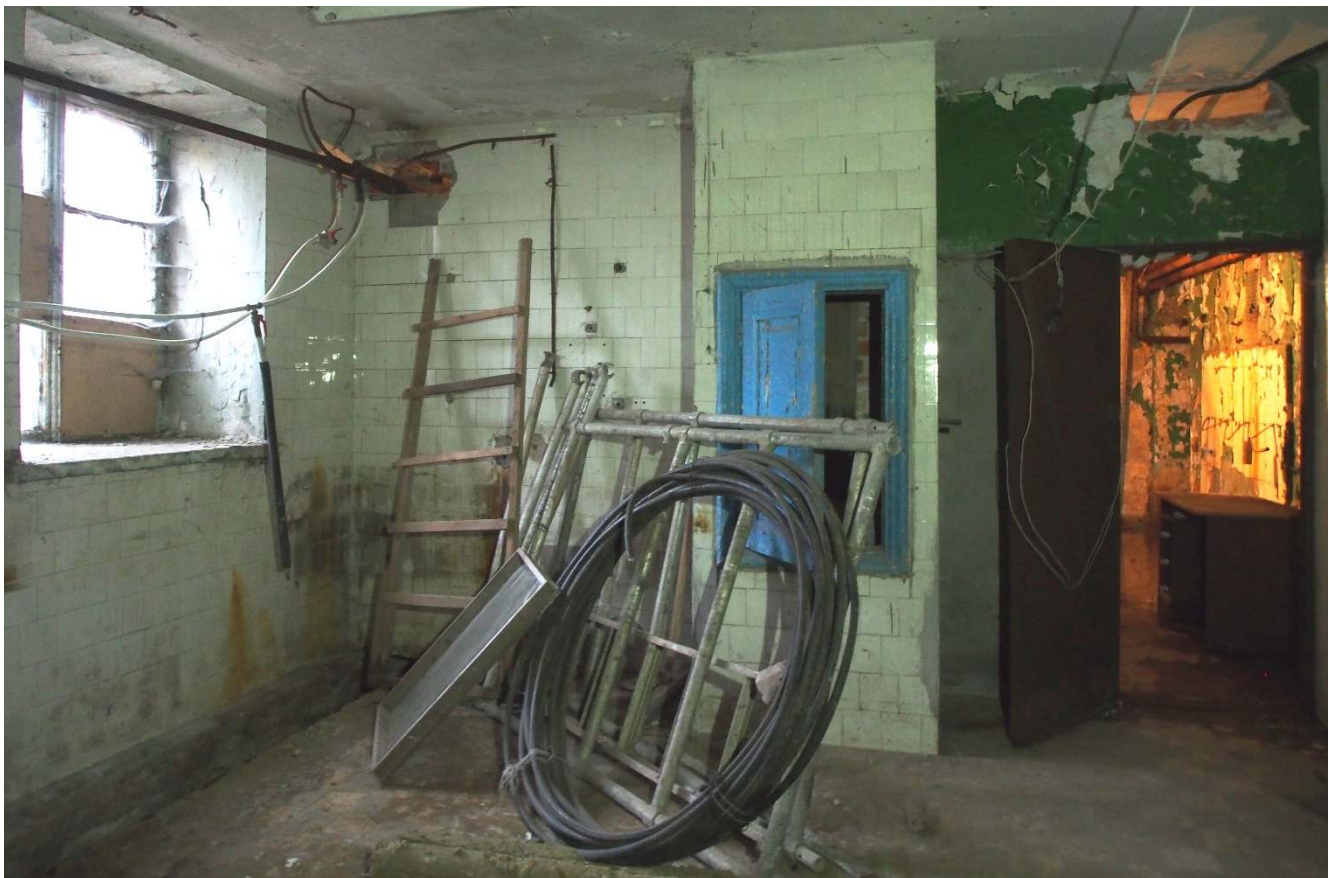
34. Шахта вентиляции в помещении подвала.
