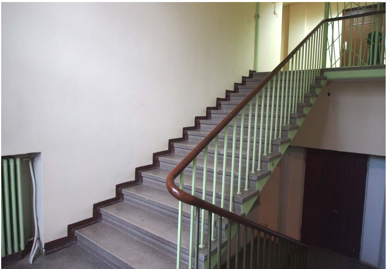
22. Лестница на второй этаж в центральной части здания. Бетонные ступени с каменной крошкой.
